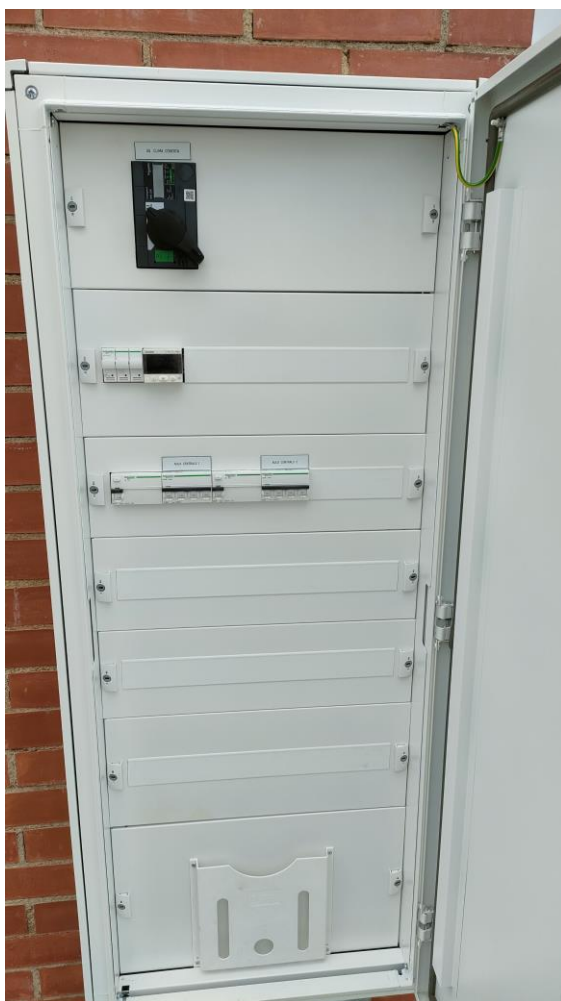
Quadre elèctric de clima existent en coberta
