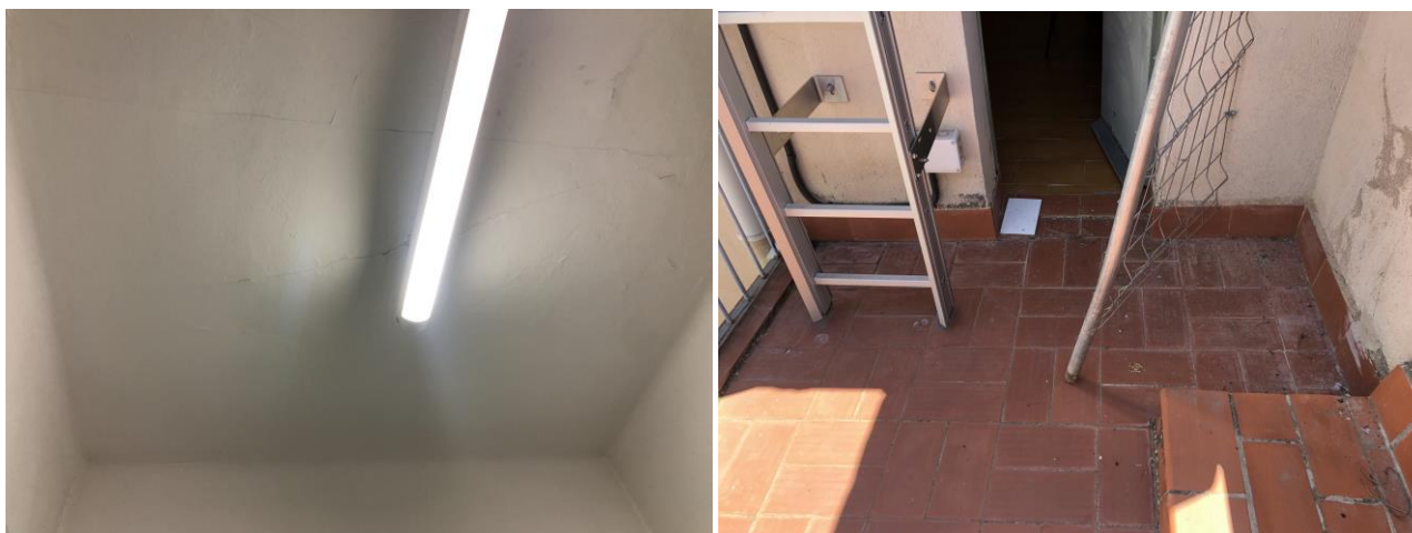
Imatges 016 i 017. Estat del fals-sostre de l'estança sud del primer pis, damunt la galeria en planta baixa, i de la terrassa superior, al segon pis.
