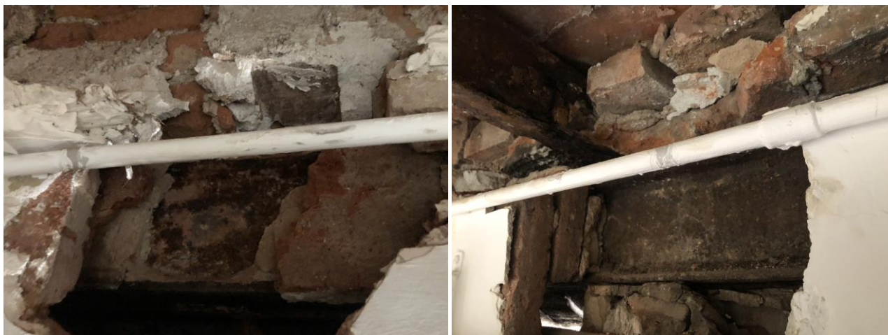
Imatges 014 i 015. Estat de la biga de ferro d'ala estreta sobre les obertures de la galeria en planta baixa. Font: Elaboració pròpia.
