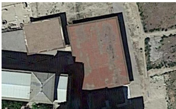
A l'esquerra coberta de la natatio amb acabat enrajolat i a la dreta coberta sense acabat i sense capa de formació de pendents. Font: googlemaps
