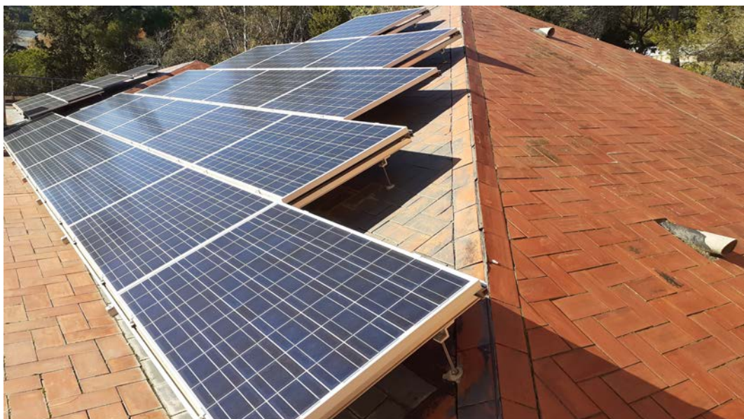
Plaques fotovoltaiques a coberta
