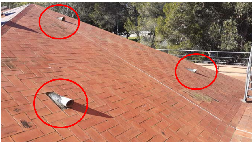
Foto 02. Conductes de ventilació piràmides cobertes
