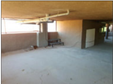
interior entreplanta nstal·lacions
