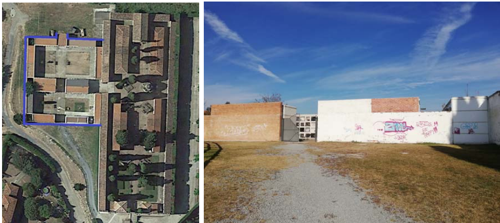
Vista de la façana sud d'accés a la part nova del cementiri. Els murs es troben alguns pintats de color blanc, amb graffitis i l'altre part del mur ceràmic totalment vist sense revestiment i també amb graffitis.
