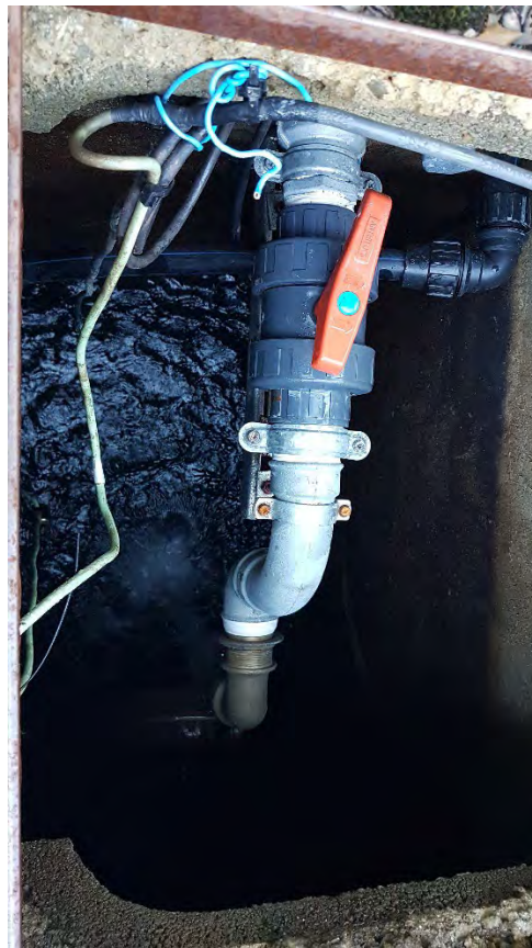
Foto 3: entrada d'aigua a dipòsit a reubicar
