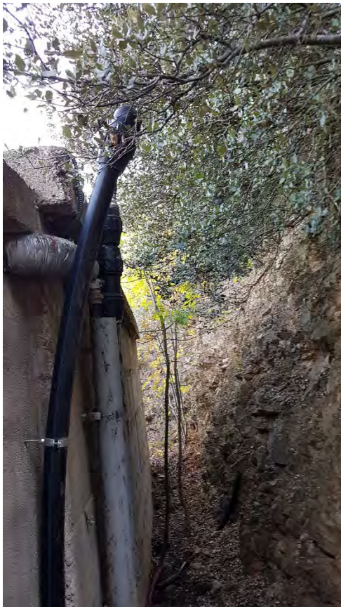
Foto 2: Canonada d'entrada i sobreeixidor a reubicar en interior de la nova caseta
