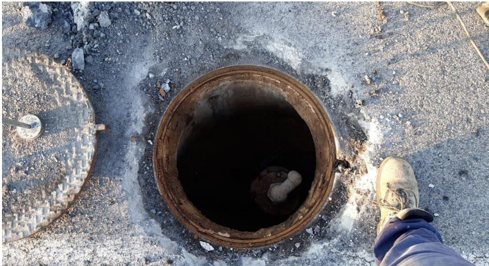
Foto: Pericó de “trencament de càrrega” amb ventosa
