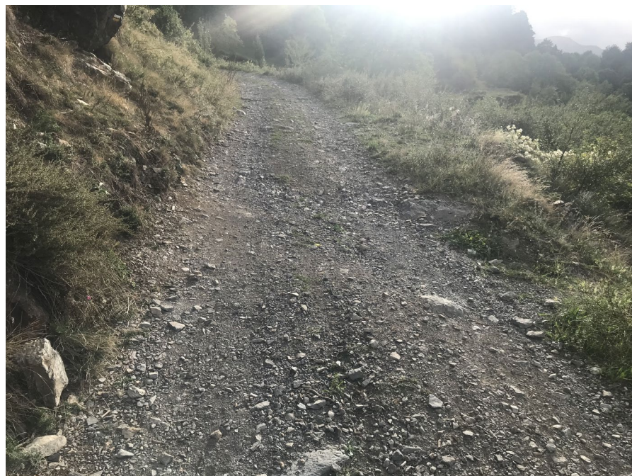
Foto 7 Baden per a drenatge transversal de la pista tan erosionat que pràcticament no compleix amb la seva funció. N'hi ha quatre més al llarg del tram.
