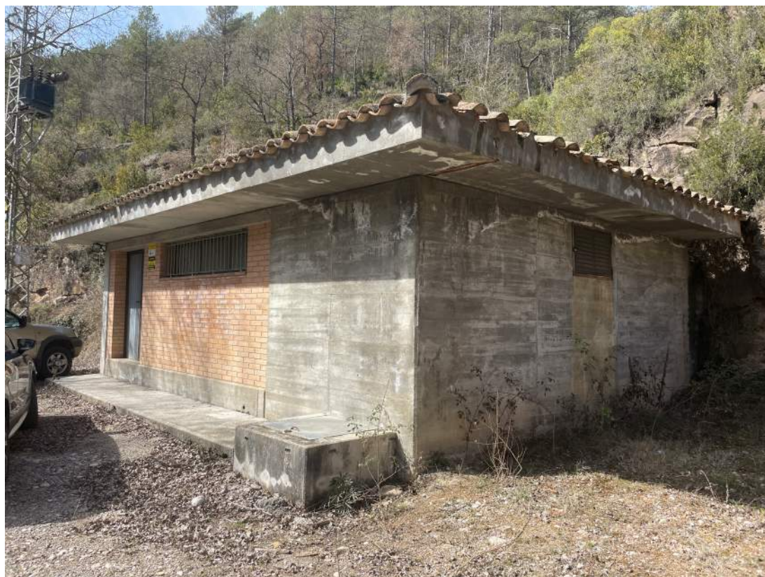
Foto 1: Caseta d'impulsió d'aigua
