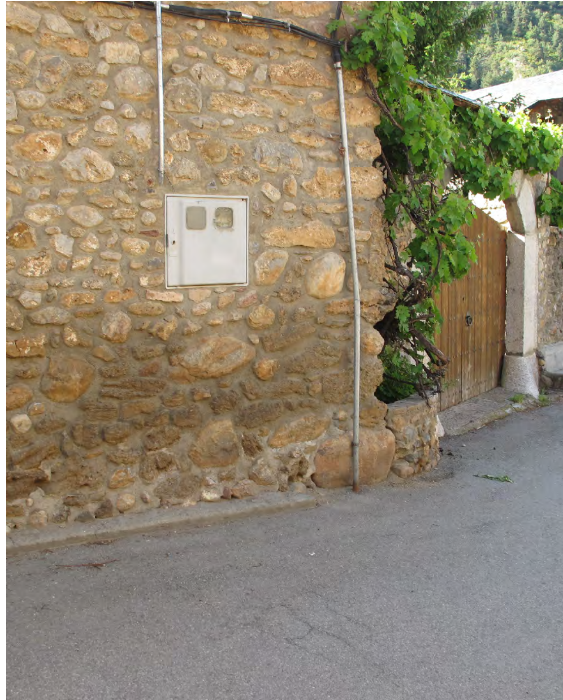
VISTA INSTAL·LACIÓ AÈRIA ACTUAL
