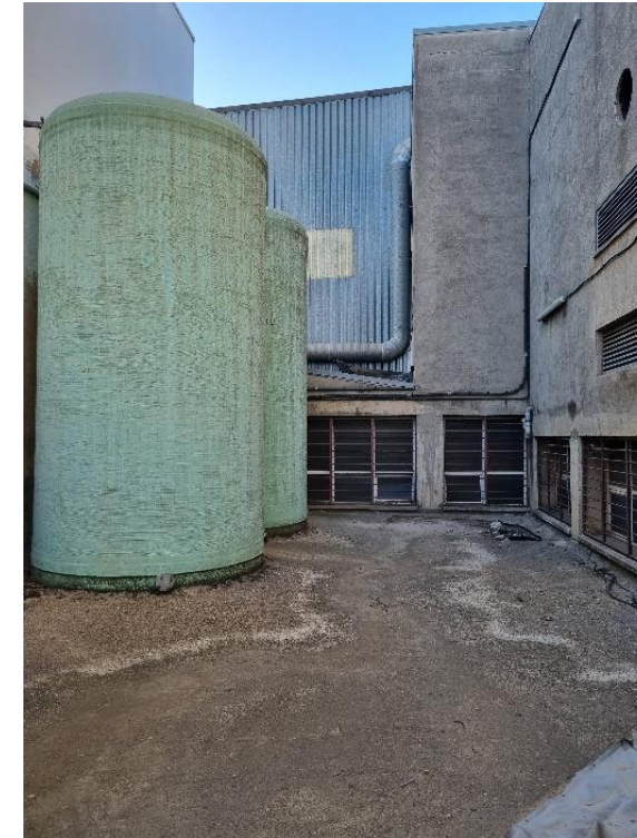
Pati Exterior ubicació el nou Grup Electrogen
