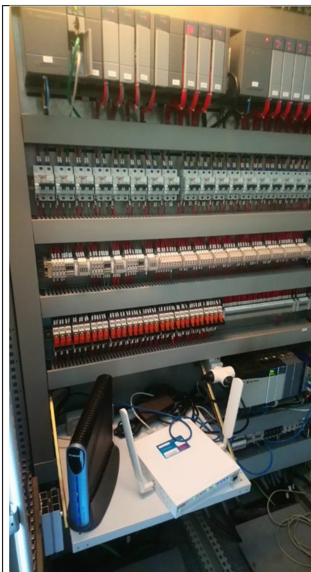
Quadre de control. Estat actual,
