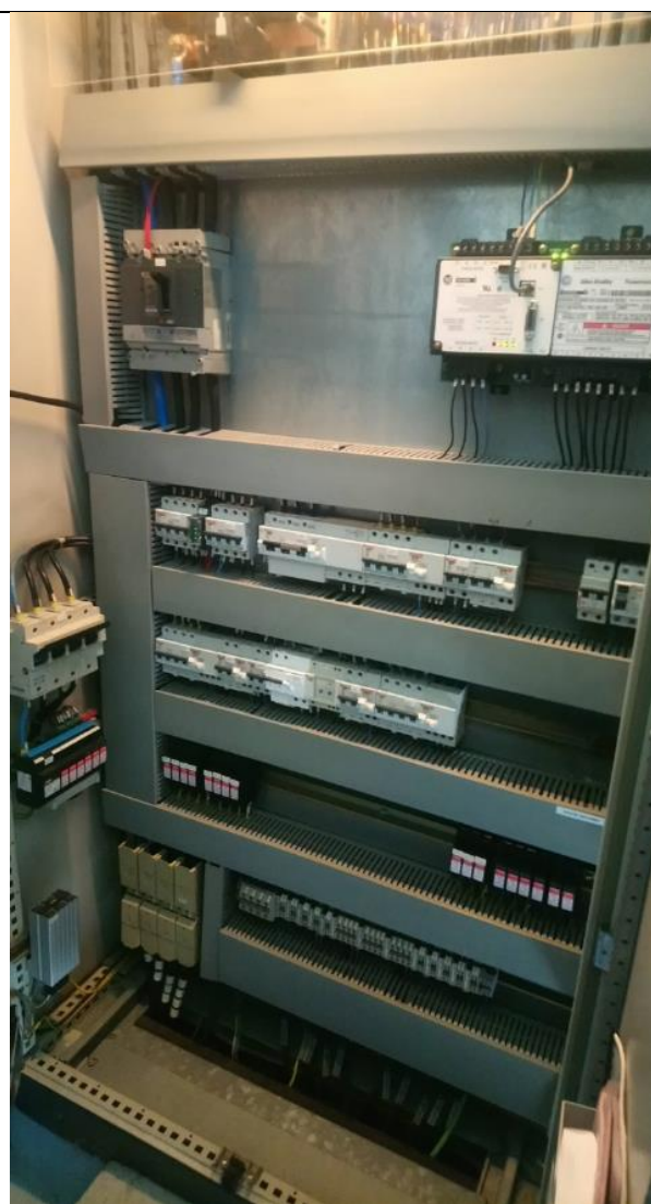
Espai existent a quadre H3PLA0201 per a encabir nou PLC.
