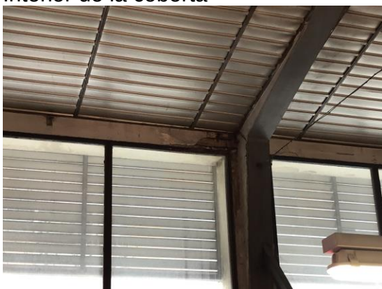
Cèrcol de formigó a reparar
