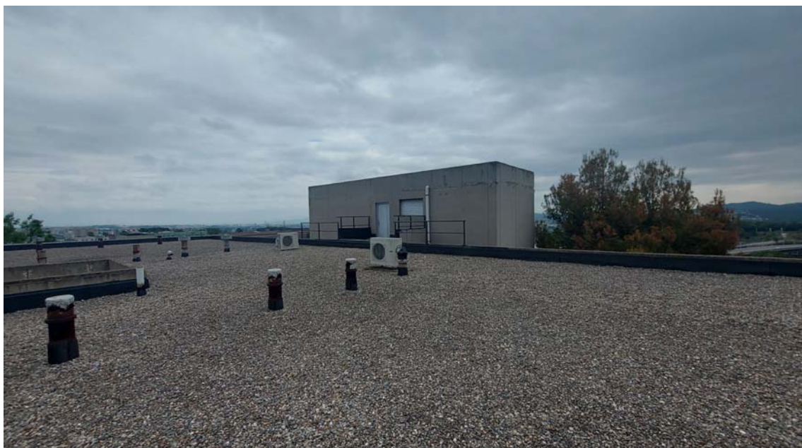
Imatge 6. Badaloc sud est M3, emplaçament inversors
