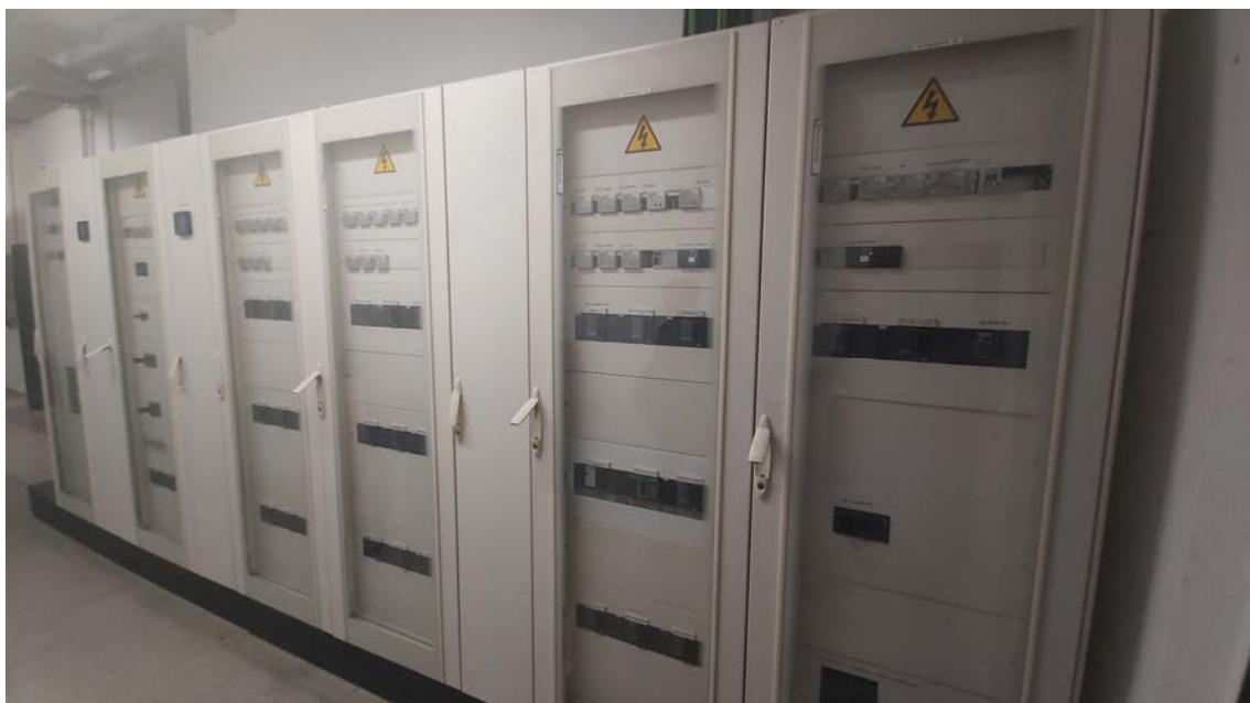
Imatge 27. Emplaçament quadre elèctric poliesportiu i porta d'accés
