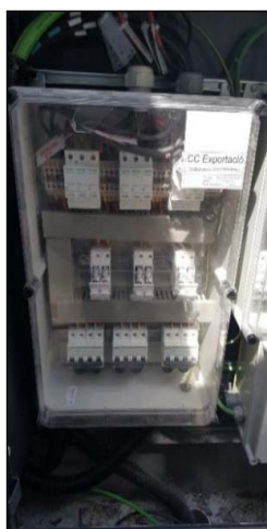
Imatge 61. Exemple de caixa de protecció CC
