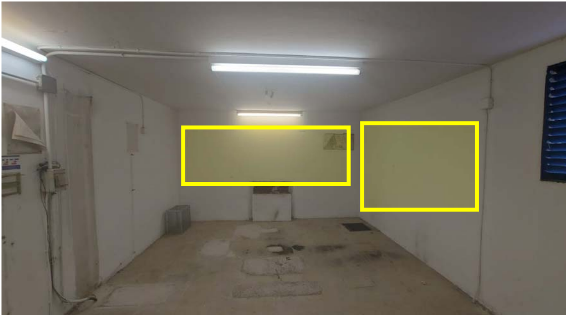
Imatge 31. En groc emplaçament inversors i caixes de protecció de CC i CA
