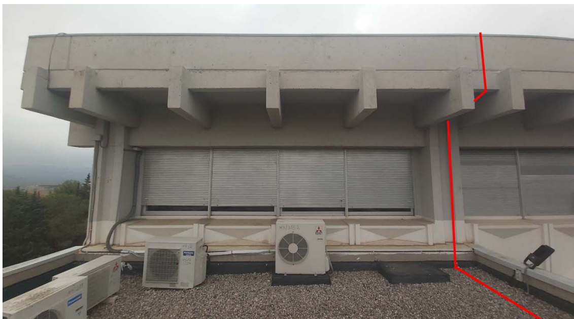
Imatge 56. Pujada cablejat CC del M0 al M3
