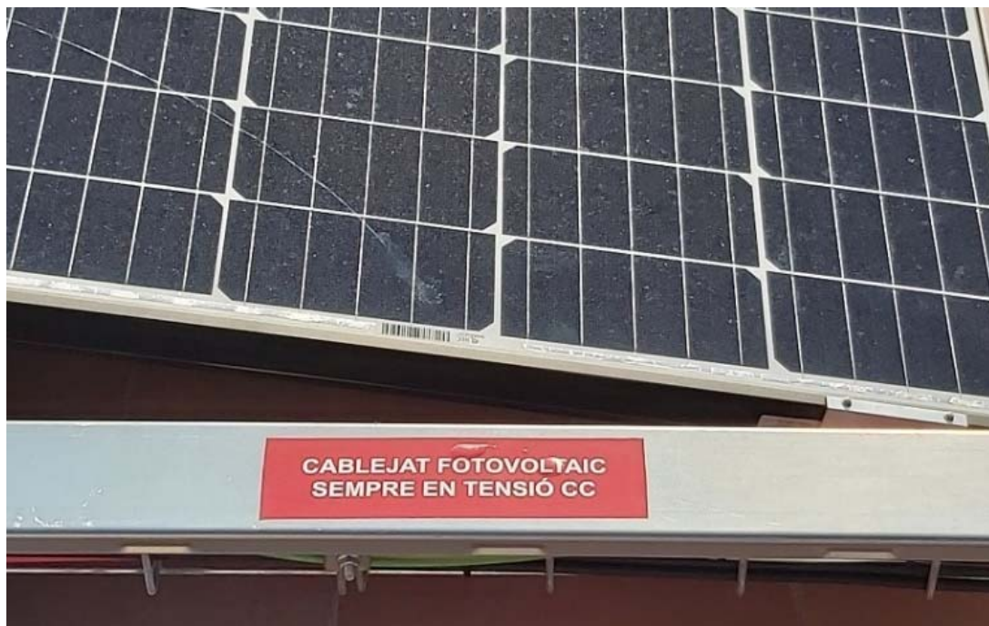
Imatge 55. Exemple de safata metàl·lica per cablejat de CC
