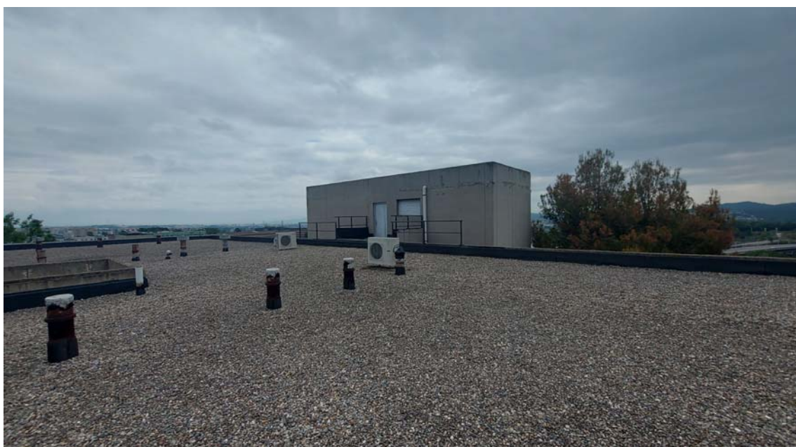
Imatge 21. Imatge badaloc sud est, emplaçament inversors edifici M3
