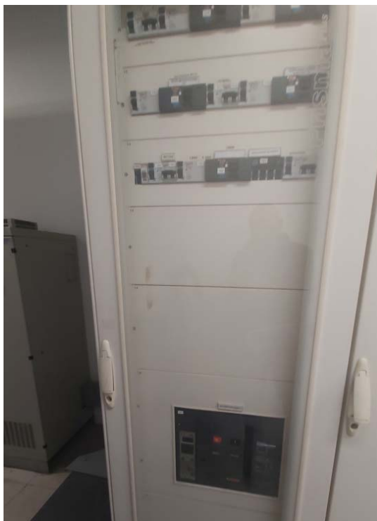
Imatge 59. Quadre on es connectarà el camp fotovoltaic
