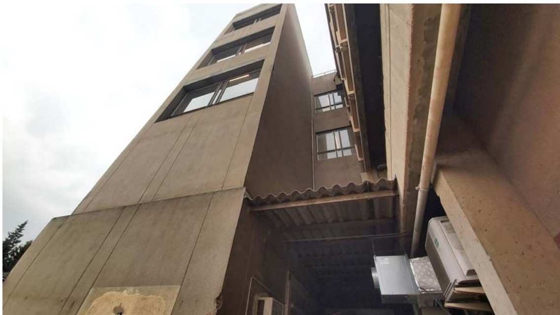
Imatge 12. Baixada de cablejat edifici M3
