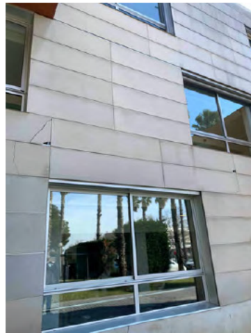
Desperfectes façana principal
