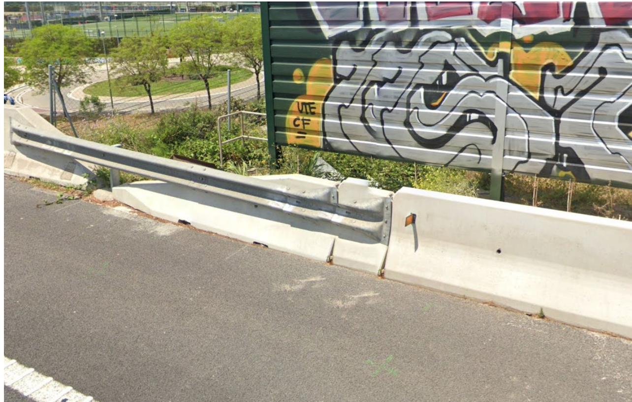
Detall de l'estat deficient del mòdul final. PK 4+626 de la B-23
