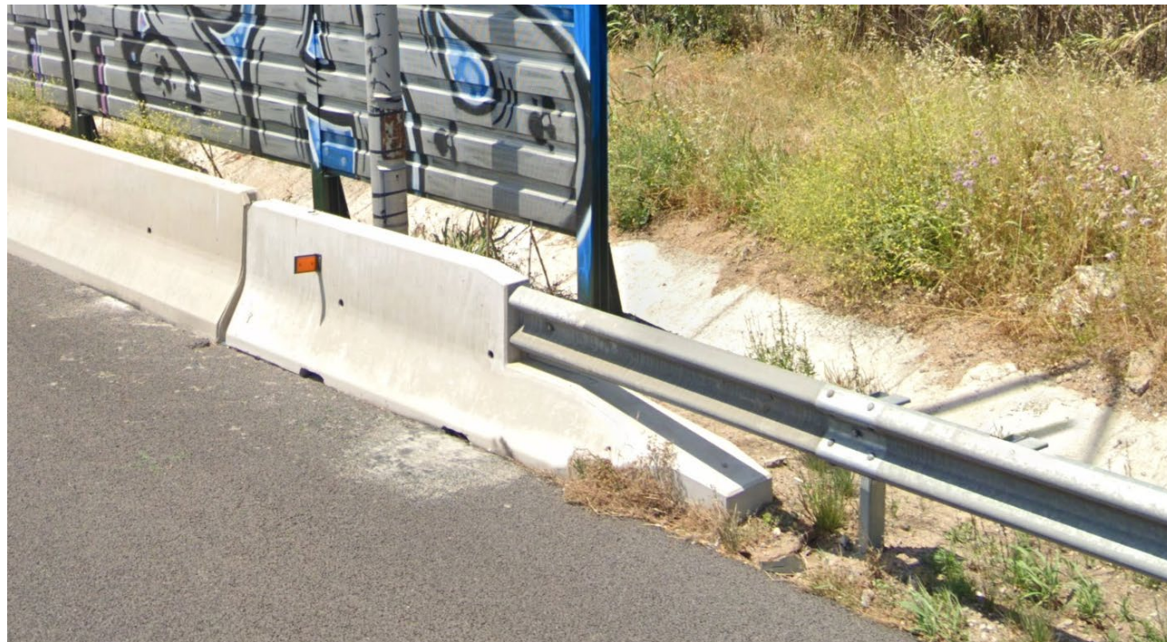
Detall de l'inici del tram de barrera al PK 4+500 de la B-23
