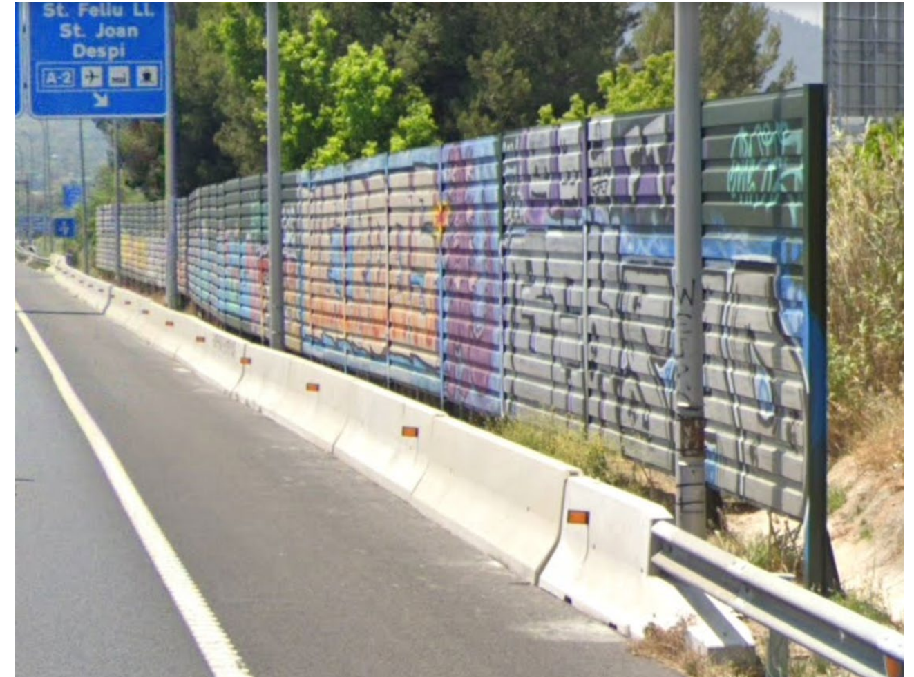
Vista de l'alineació deficient del tram de barrera
