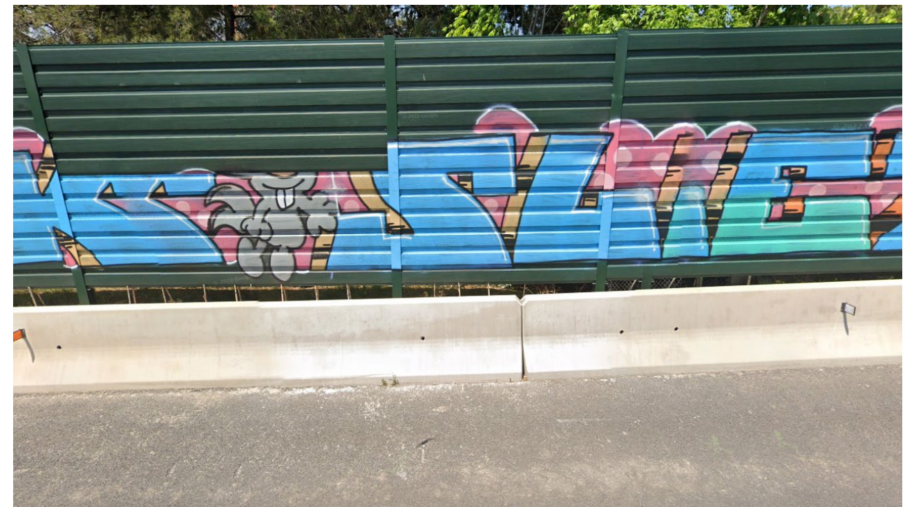
Detall on s'observa la falta dels orificis de drenatge de la barrera actual
