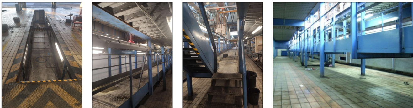
Ubicació zona columna elevadora hidràulica en fossat de taller.
