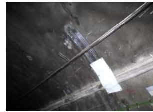
Filtració tapada a sostre
