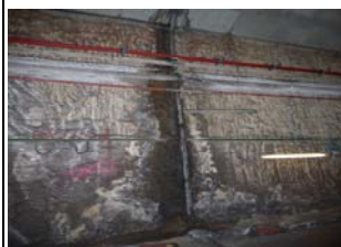
Filtració a lateral per junta
