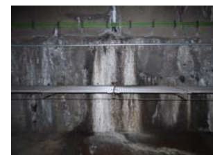
Filtració amb precipitat a lateral
