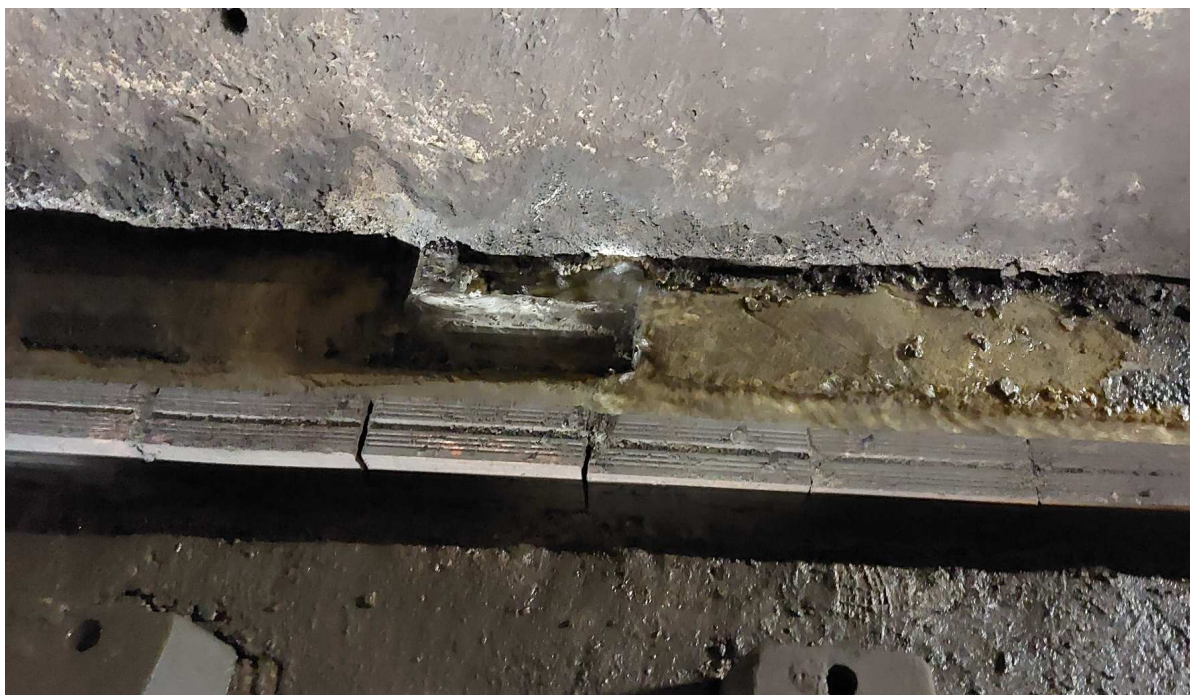
Imatge 21. Imatge filtració PK110+470 coincident amb tram via travesses STEDEF.
