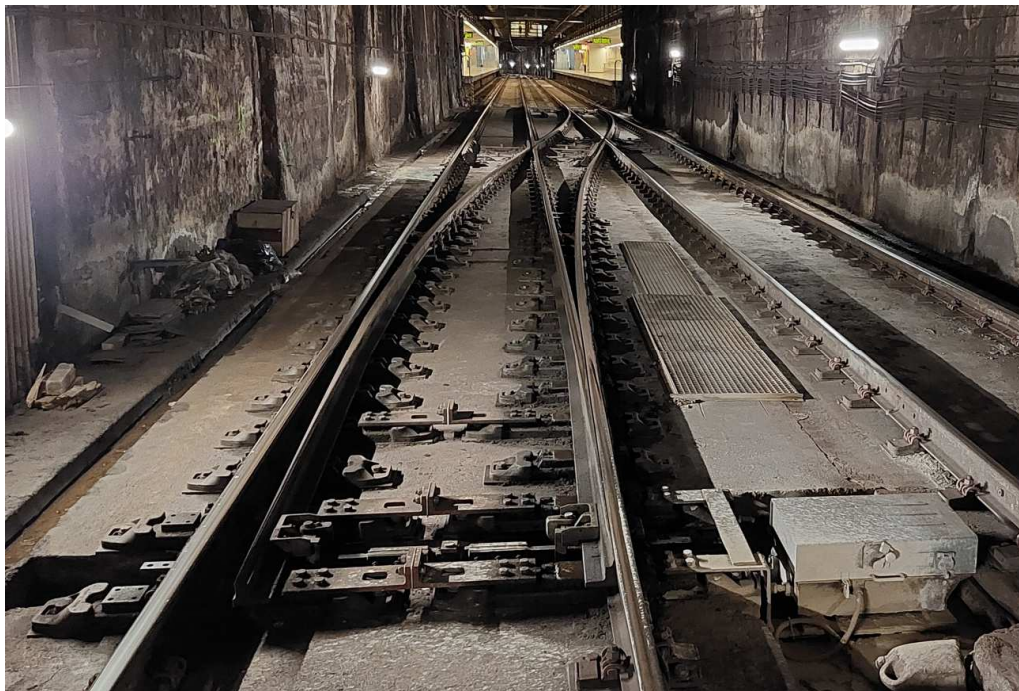
Imatge 7. Aparell de via Artigues-Sant Adrià
