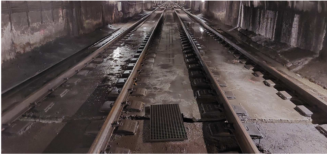
Imatge 12. Estat plataforma de via sortida Gorg cap a Pep Ventura amb drenatge central embussat.
