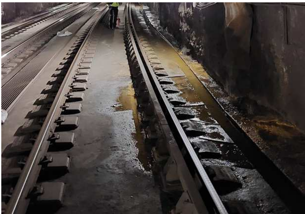
Imatge 16. Punt acumulació aigua al PK109+550.
