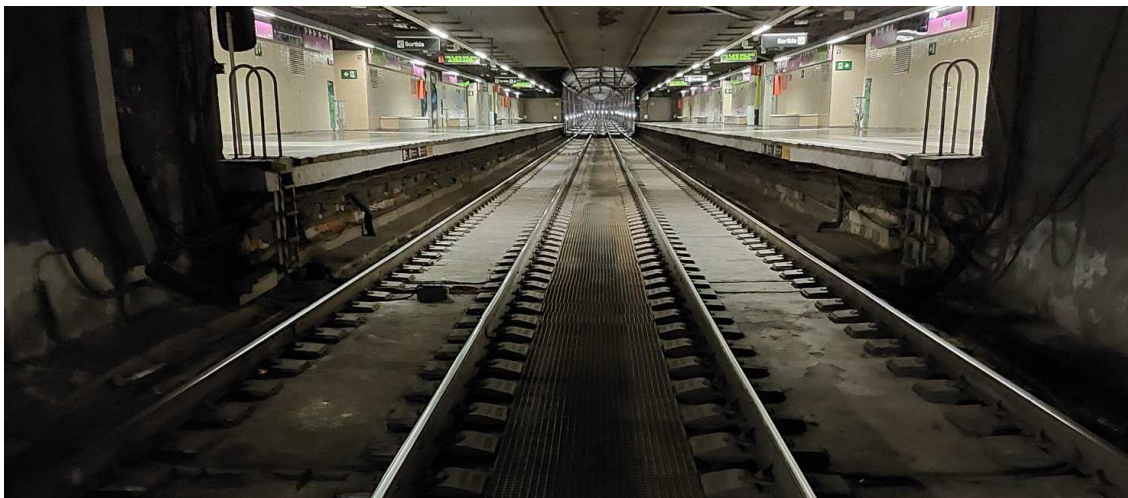
Imatge 1. Fotografia de l'estació de Gorg amb drenatge central a celobert cobert amb reixa plàstica.
