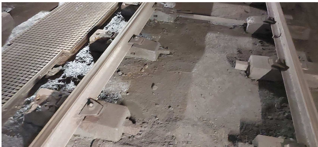
Imatge 2. Fotografia exemple travesses bibloc deteriorades
