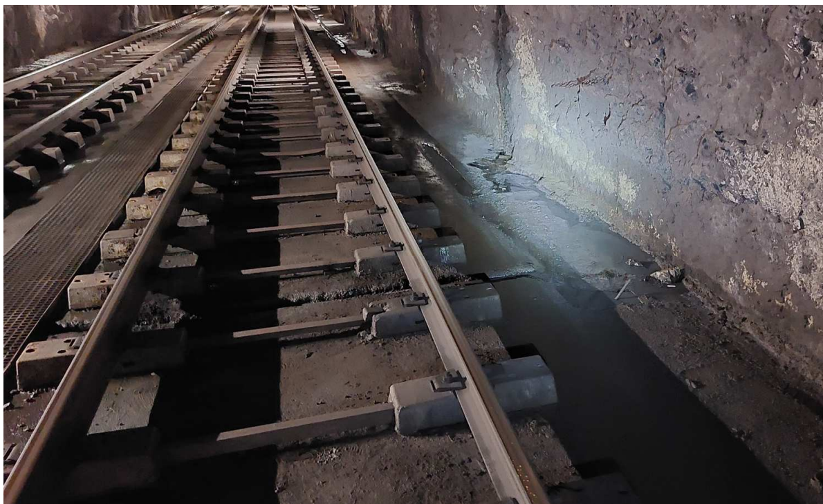
Imatge 15. Punt acumulació aigua al PK109+235 amb drenatge transversal insuficient.
