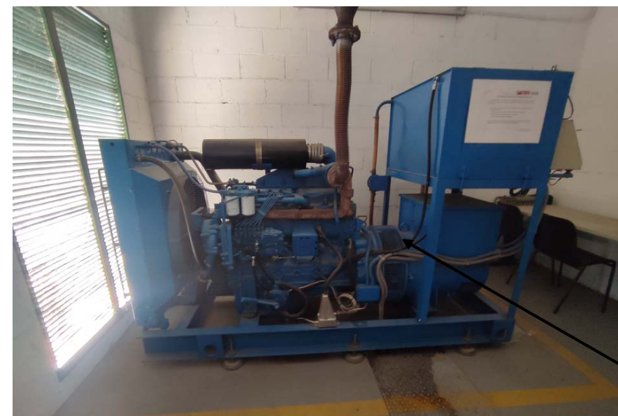
GRUP 165KVA A RETIRAR ESPAI LLIURE PER QUADRES B.T.
