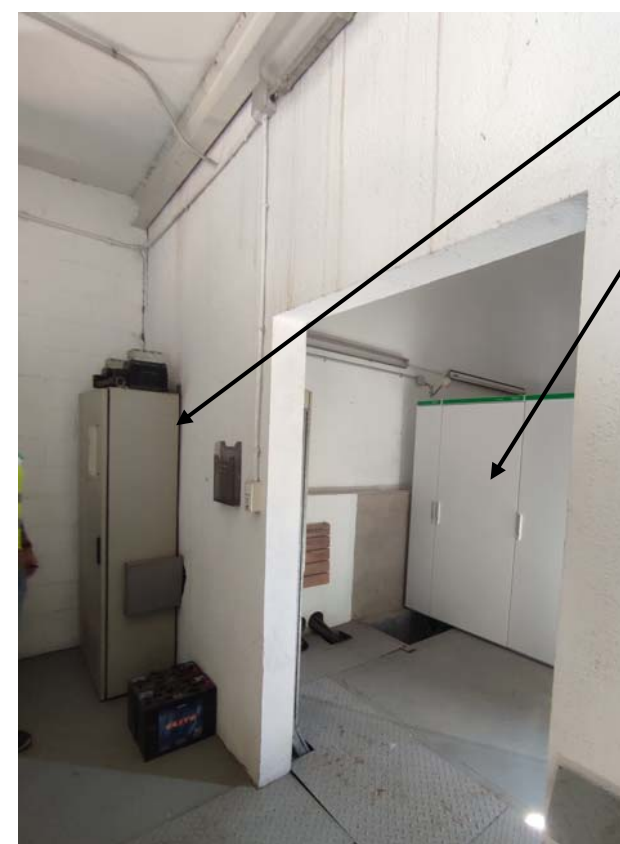
QUADRE COMMUTACIÓ B.T. ACTUAL
