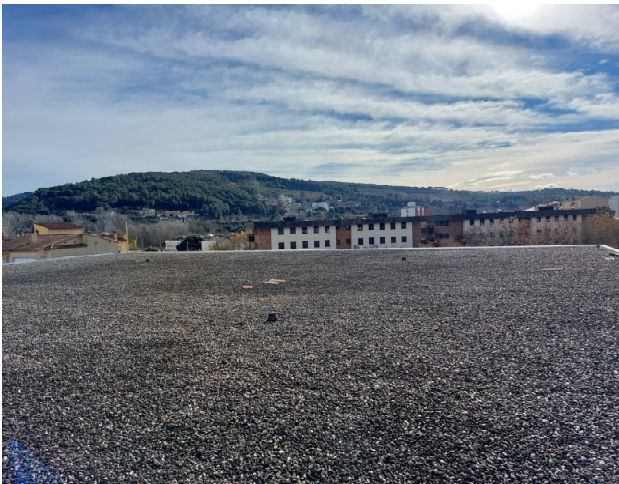
Coberta superior, en la qual se situa el camp fotovoltaic
