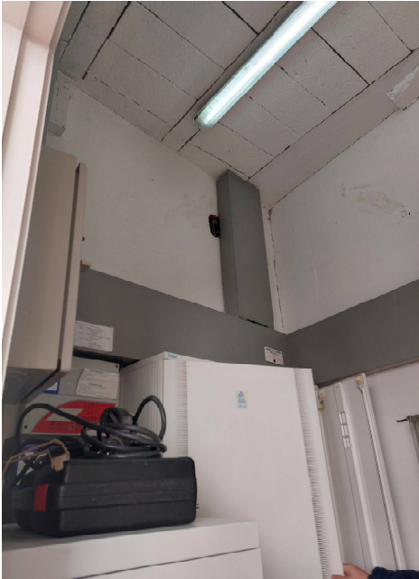
Interior zona quadre elèctric en la qual se situarà inversor
