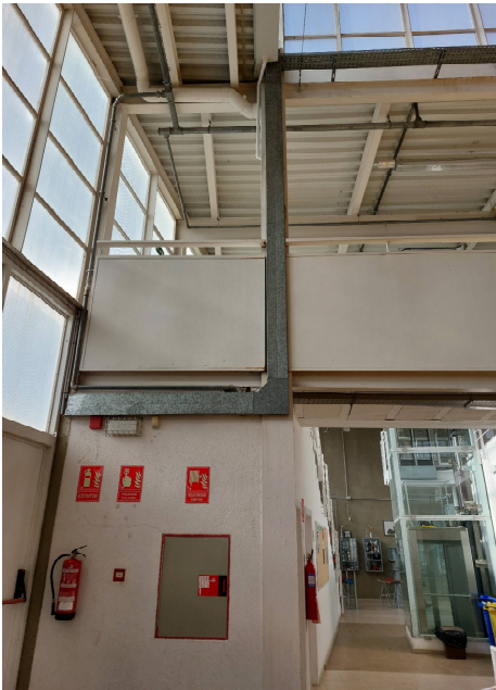
Interior de pavelló
