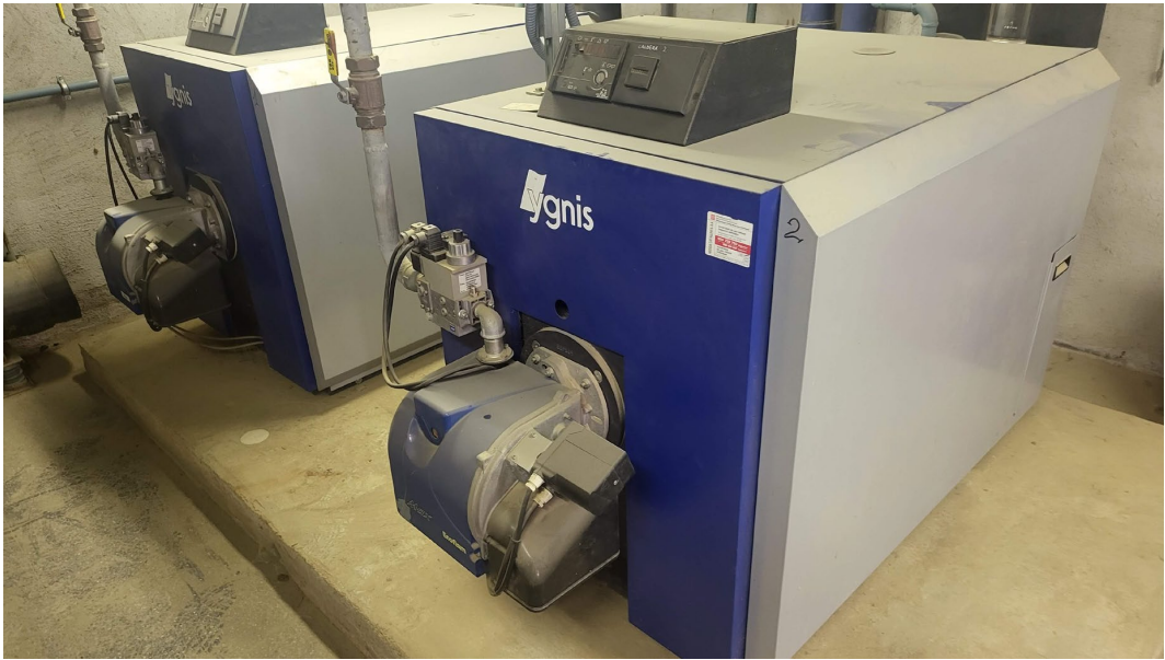
Calderas Actuales Ygnis de 158 KW unitarios a eliminar
