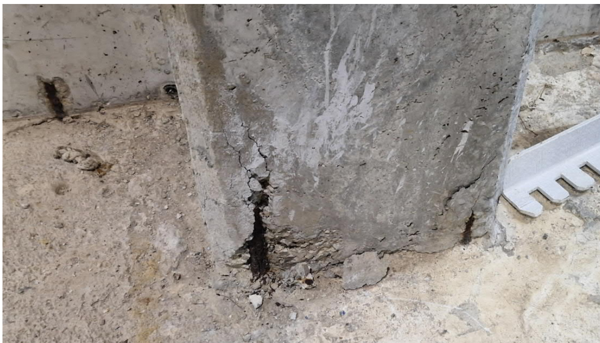
Figura 12. Arrencada de pilars laterals on s'aprecia una esquerda molt significativa en les 4 cantonades. La longitud d'aquesta fissura és de l'ordre de 60cm en totes les cantonades. Els pilars presenten un procés de corrosió avançat amb escrostonaments patents (fins i tot en murs). Fotografia de 06/02/2023
