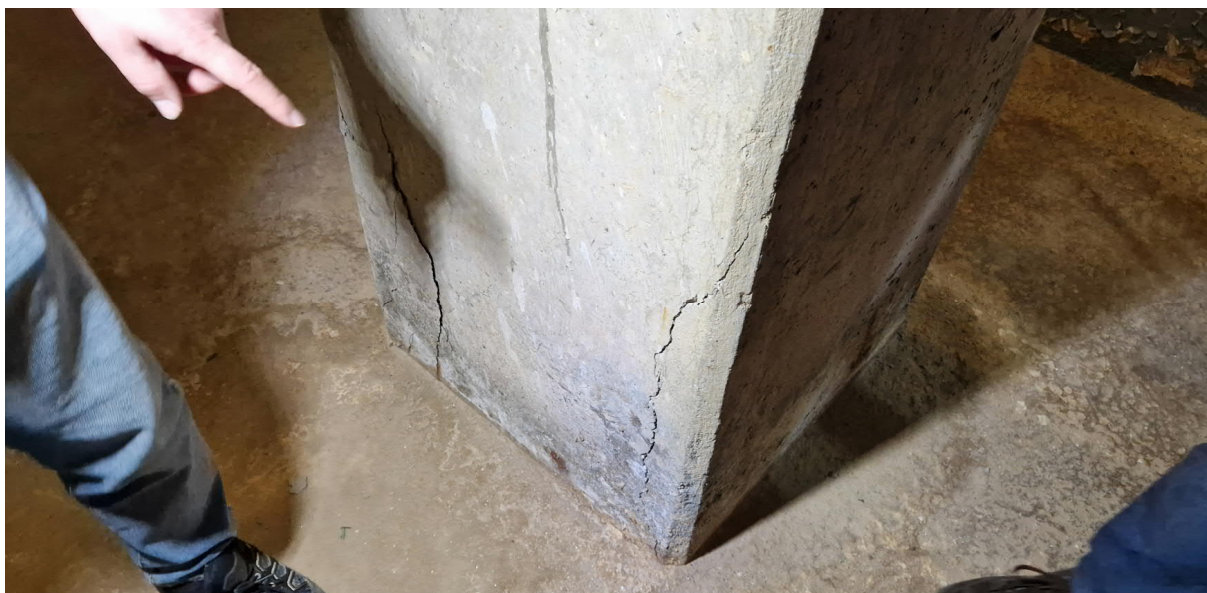
Figura 11. Arrancada de pilars centrals on s'aprecia una esquerda molt significativa en les 4 cantonades. La longitud d'aquesta fissura és de l'ordre a 60cm en totes les cantonades. Molt presumiblement els pilars presenten un procés de corrosió avançat. Fotografia de 06/02/2023
