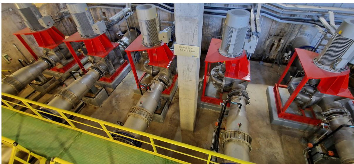
Figura 10. Zona de bombament d'aigua de mar, amb pilars centrals arrencats en llosa de fonamentació, en ambient altament marí, amb precipitats continus d'aigües de mar. Fotografia de 06/02/2023
