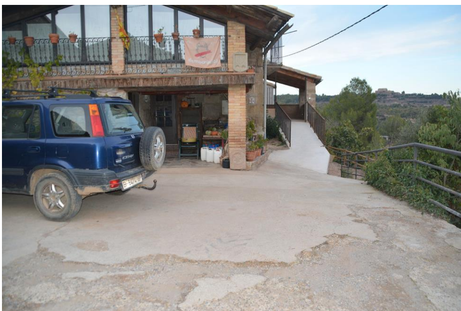
Foto 2: VISTA DE LA PART DE LA PLAÇA ON CAL REFER EL PAVIMENT DETERIORAT
