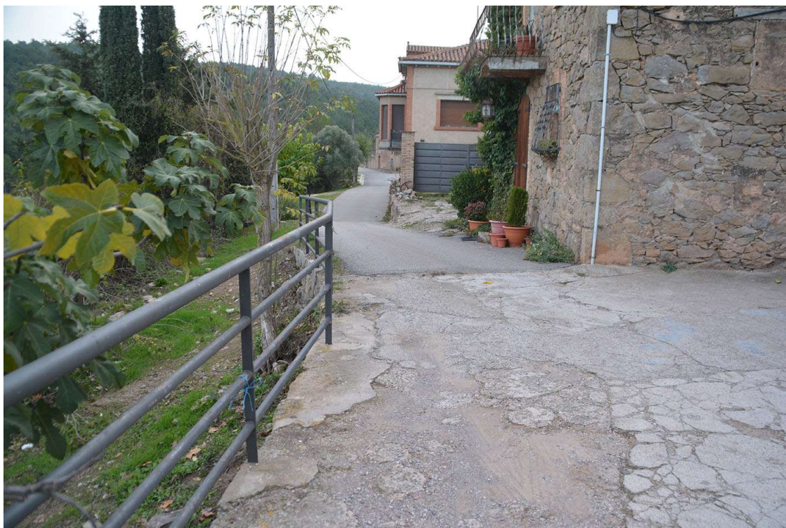
Foto 5: ZONA D'ARRIBADA A LA PLAÇA, AMB EL VIAL ASFALTAT I LA PLAÇA AMB EL PAVIMENT DETERIORAT
