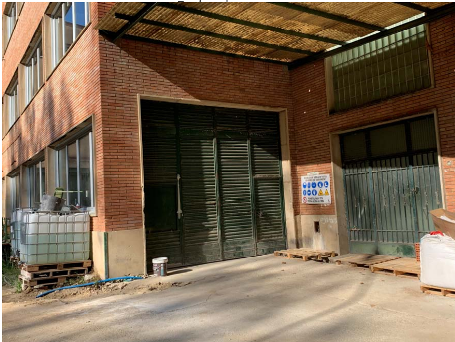
Foto 02_ Façana i porta P1 a substituir
