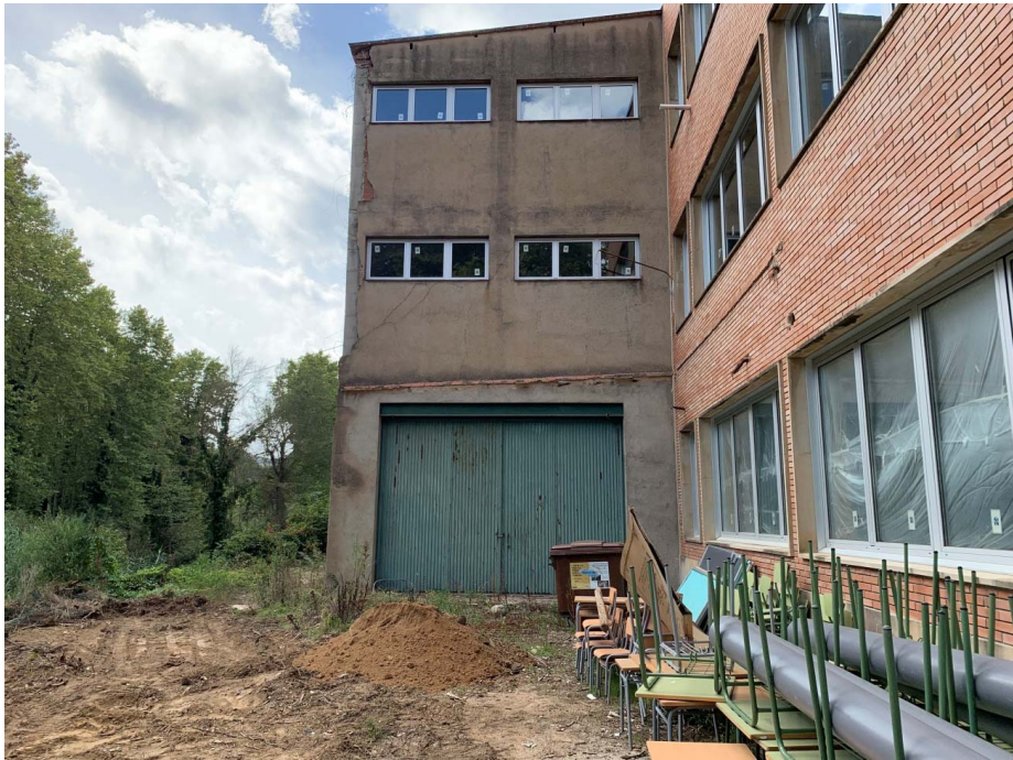
Foto 01_ Façana i porta P2 a substituir
