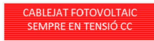
Figura 14. Senyalització cablejat CC. Font: Bombers de Barcelona.
