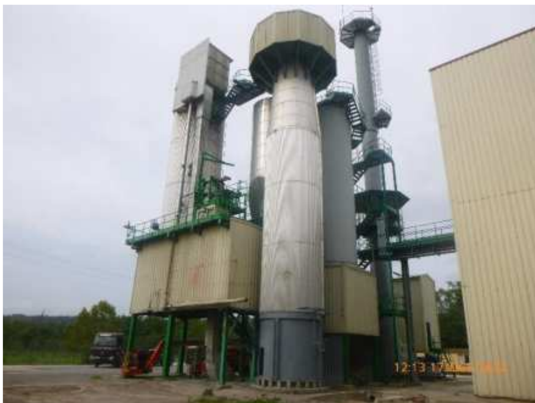
Imatge 1 – Vista general del sistema de depuració de gasos de la PVE de Girona
