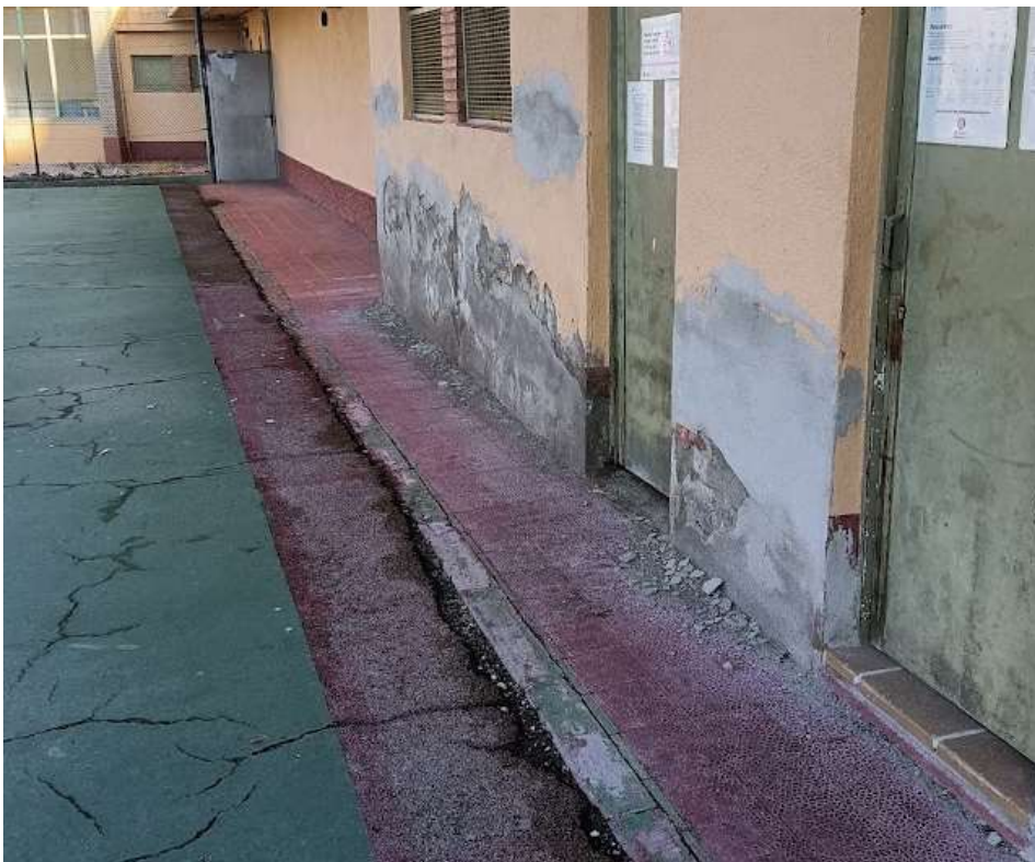
Foto 3: Revestiments de paraments verticals en mal estat.
