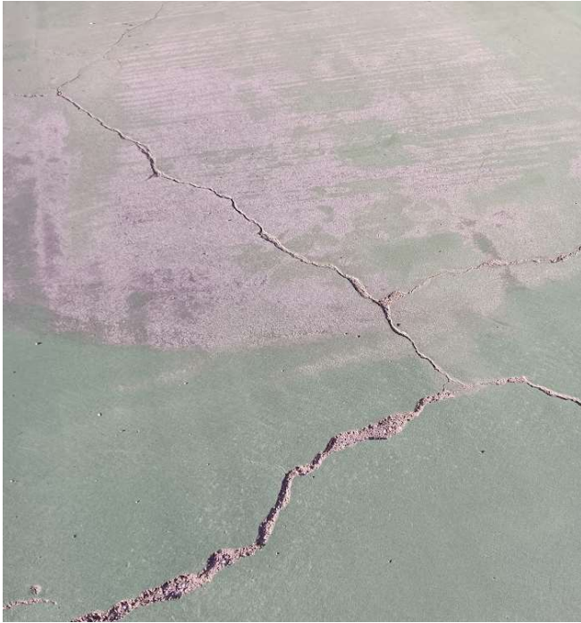
Foto 4: Esquerdes, fissures i desgast del paviment .
