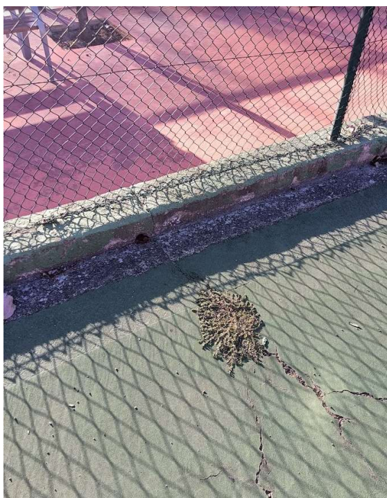
Foto 7: Fissures i sortides de plantes en pista 2.
