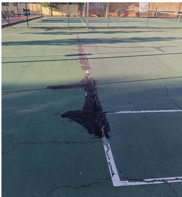
Foto 1: Fissures i esquerdes en el paviment continu.
