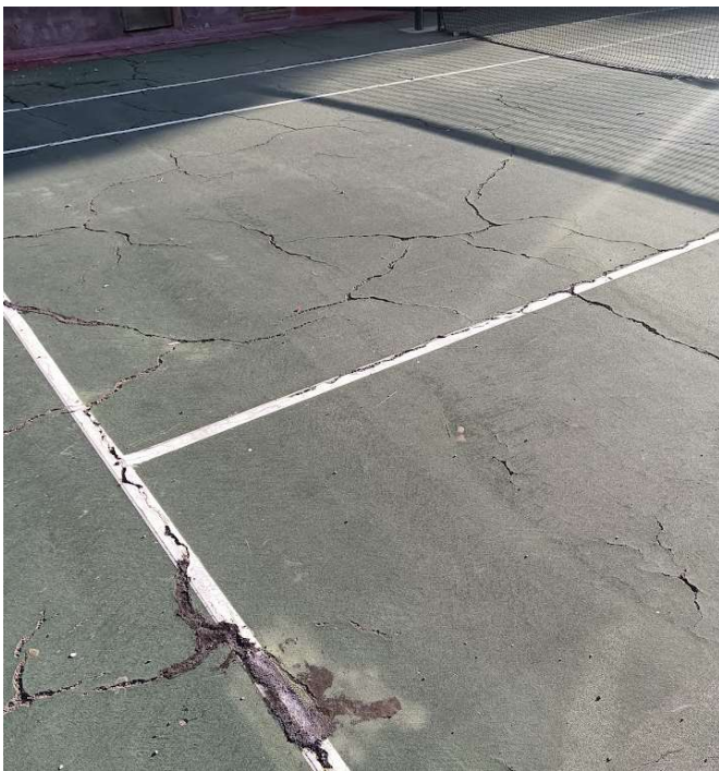
Foto 5: Esquerdes, fissures i reparacions de manteniment.
