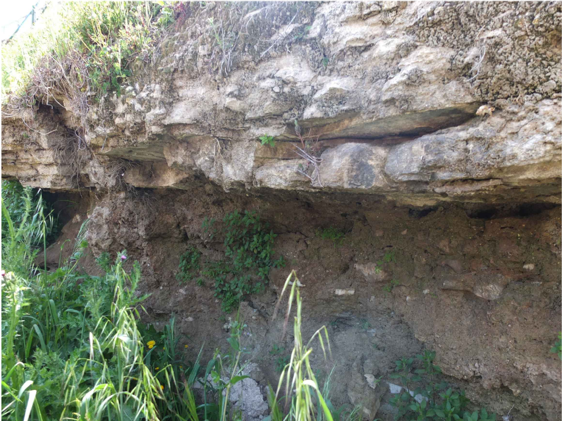
V3. Balmes suscavades sobre els estrats de la pedra de guix del basament. Descompressió. Inestabilitat. Font: GAA 19/04/2018
