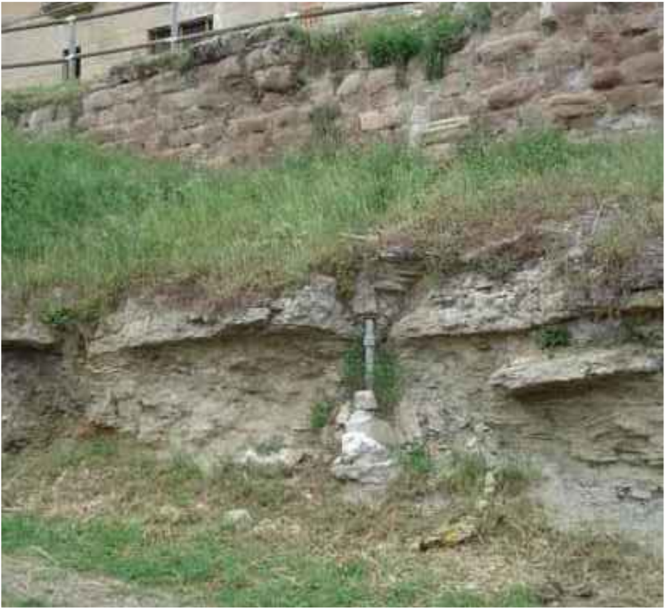
V16. Vista dels diferents estrats de guix massiu i guix granular del basament de la torre. Soscavacions i presència de vegetació. Font: Berga Geoconsultec
