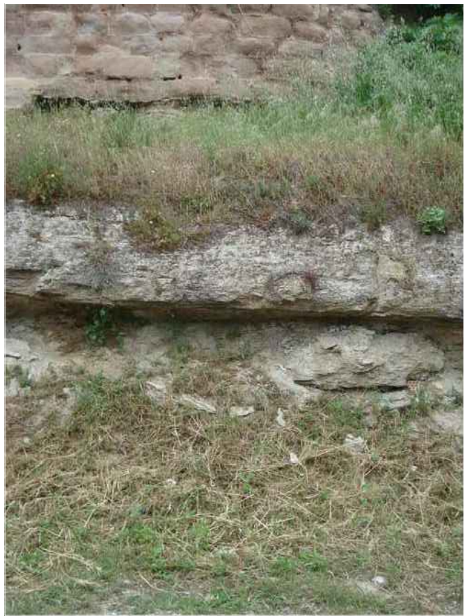
V14. Vista dels diferents estrats de guix massiu i guix granular del basament de la torre. Soscavacions i presència de vegetació. Font: Berga Geoconsultec
