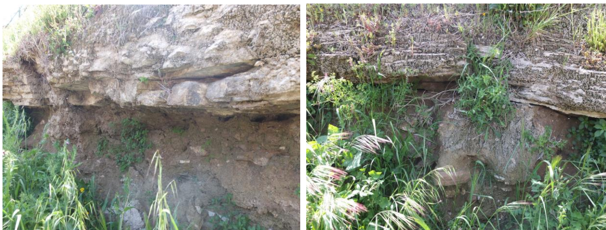
Imatges de l'erosió del basament de la torre degut en part a les infiltracions d'aigua i presència de vegetació en els estrats rocósos que facilita l'esmicolament del guix granular. Font: GAA 19/04/2018
