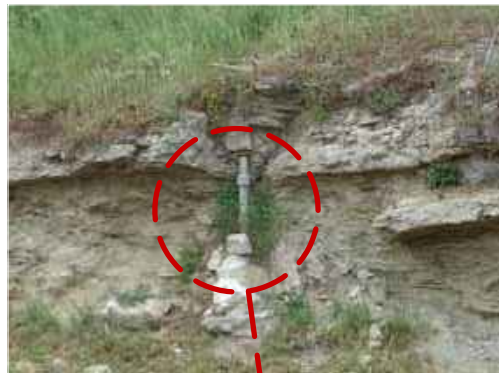
Canonades d'instal·lacions. Degradació granular.
