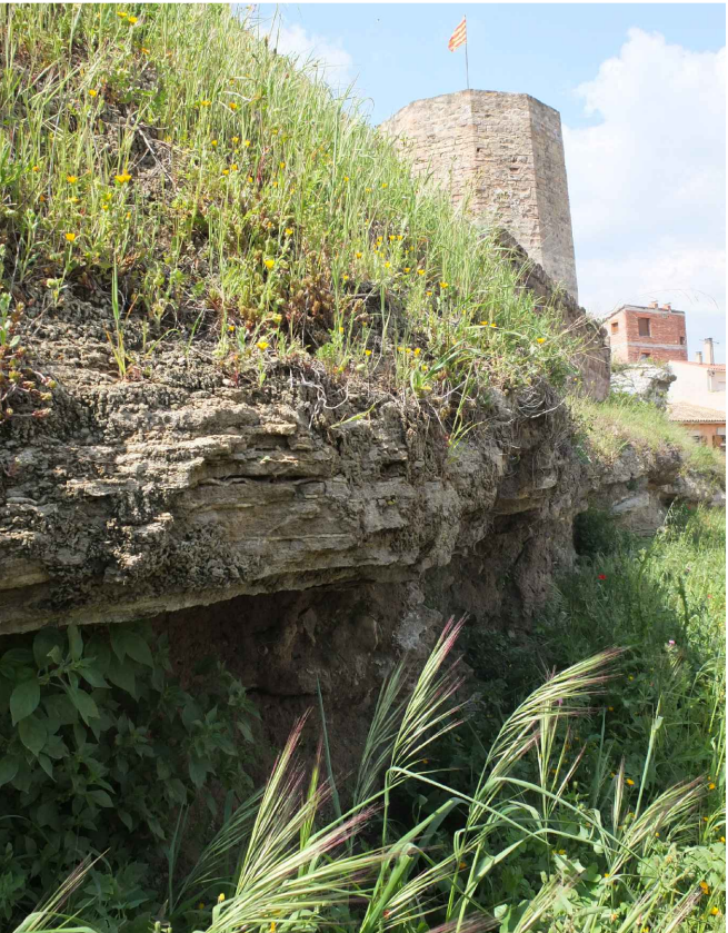
V5. Degradació dels diferents estrats rocosos del basament de la torre. Presència de pedres de guix granular. Font: GAA 19/04/2018
