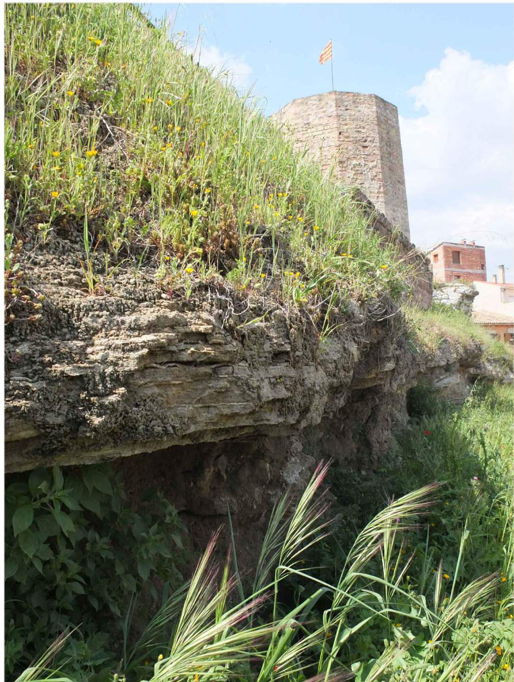
V17. Vista dels diferents estrats de guix massiu i guix granular del basament de la torre. Soscavacions i presència de vegetació. Font: Berga Geoconsultec
