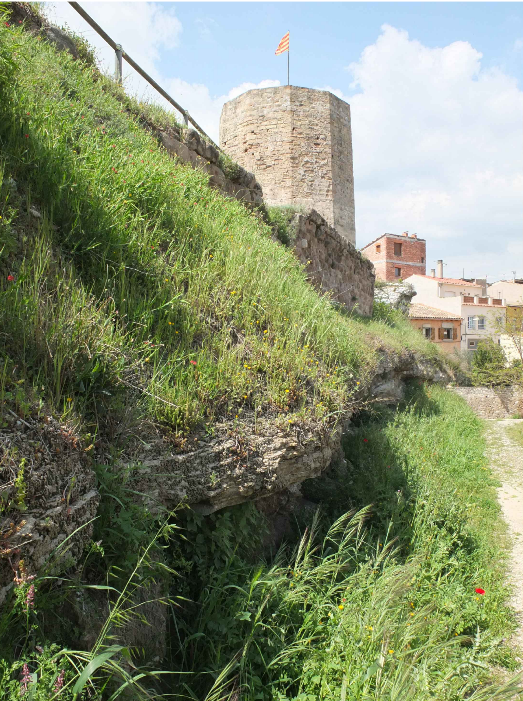
V15. Vista del talús fora de l'àmbit de la muralla medieval. A primer pla, les balmes soscavades i descalçament dels estrats de pedra de guix. Font: GAA 19/04/2018
