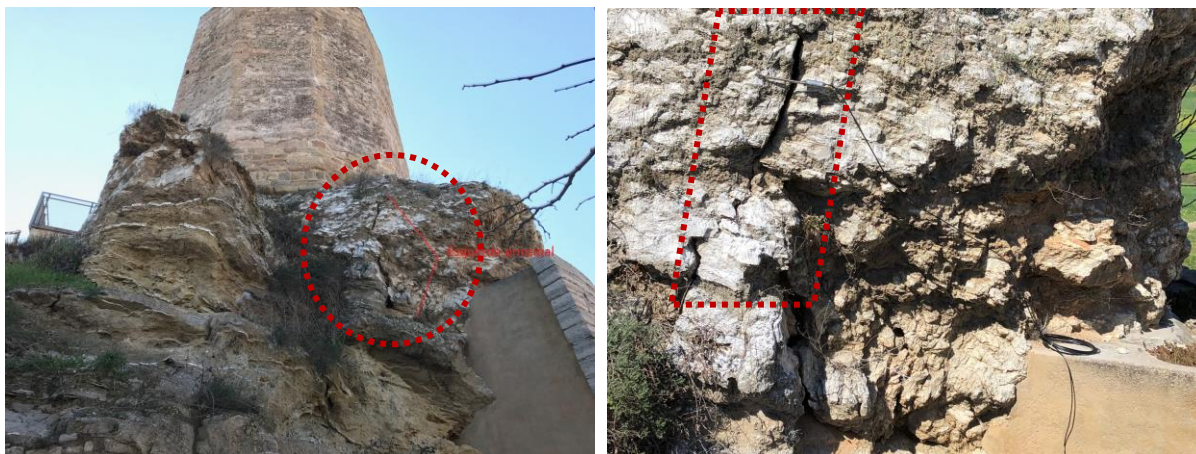
Imatges de la fissura vertical de l'estrat rocós del basament. Font: Berga Geoconsultec i GAA
