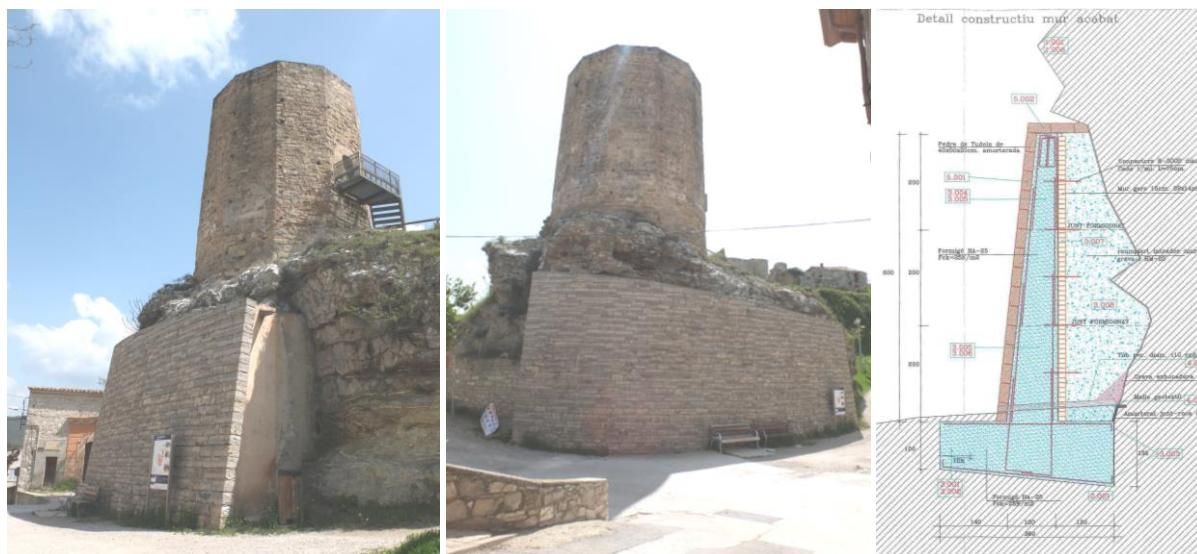
Imatges del mur de contenció realitzat l'any 2003. Detall constructiu del mur de formigó armat. Font: GAA
