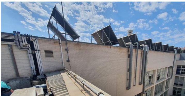
Foto 10 Plaques solars tèrmiques
