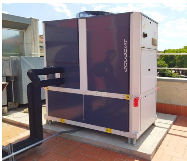
Foto 08. Bomba de Calor
