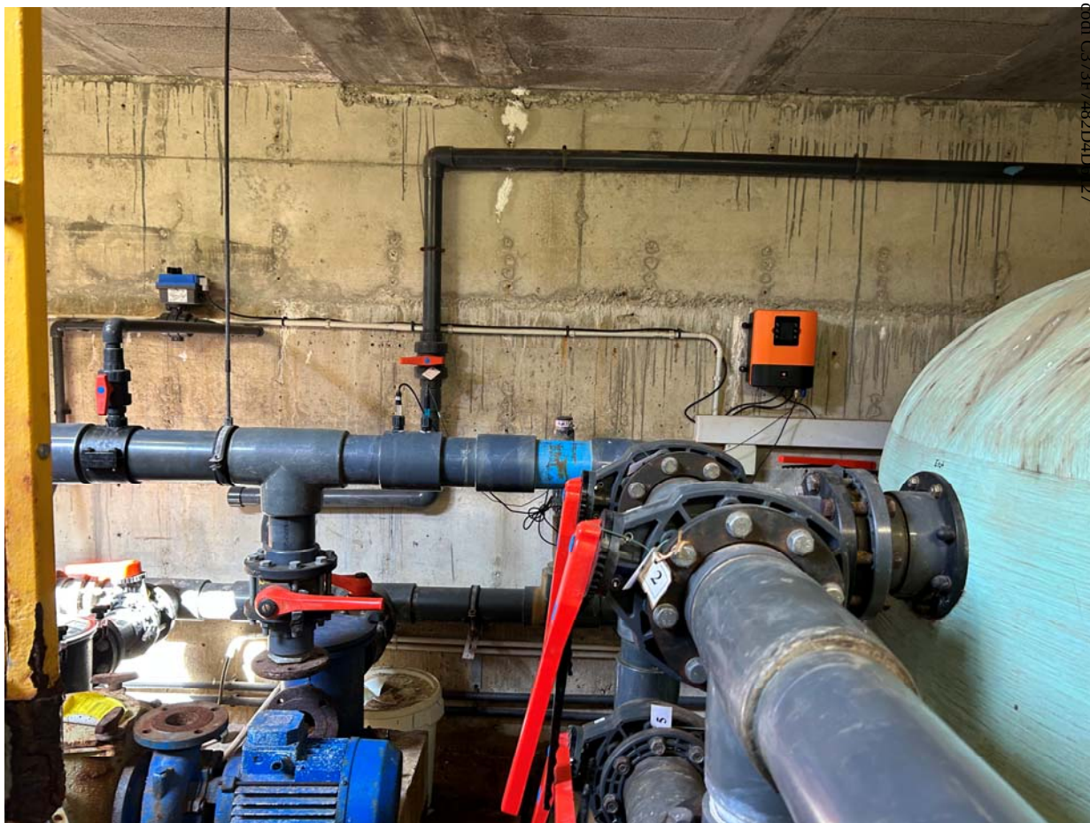
Bomba i col·lector caseta depuració soterrada
