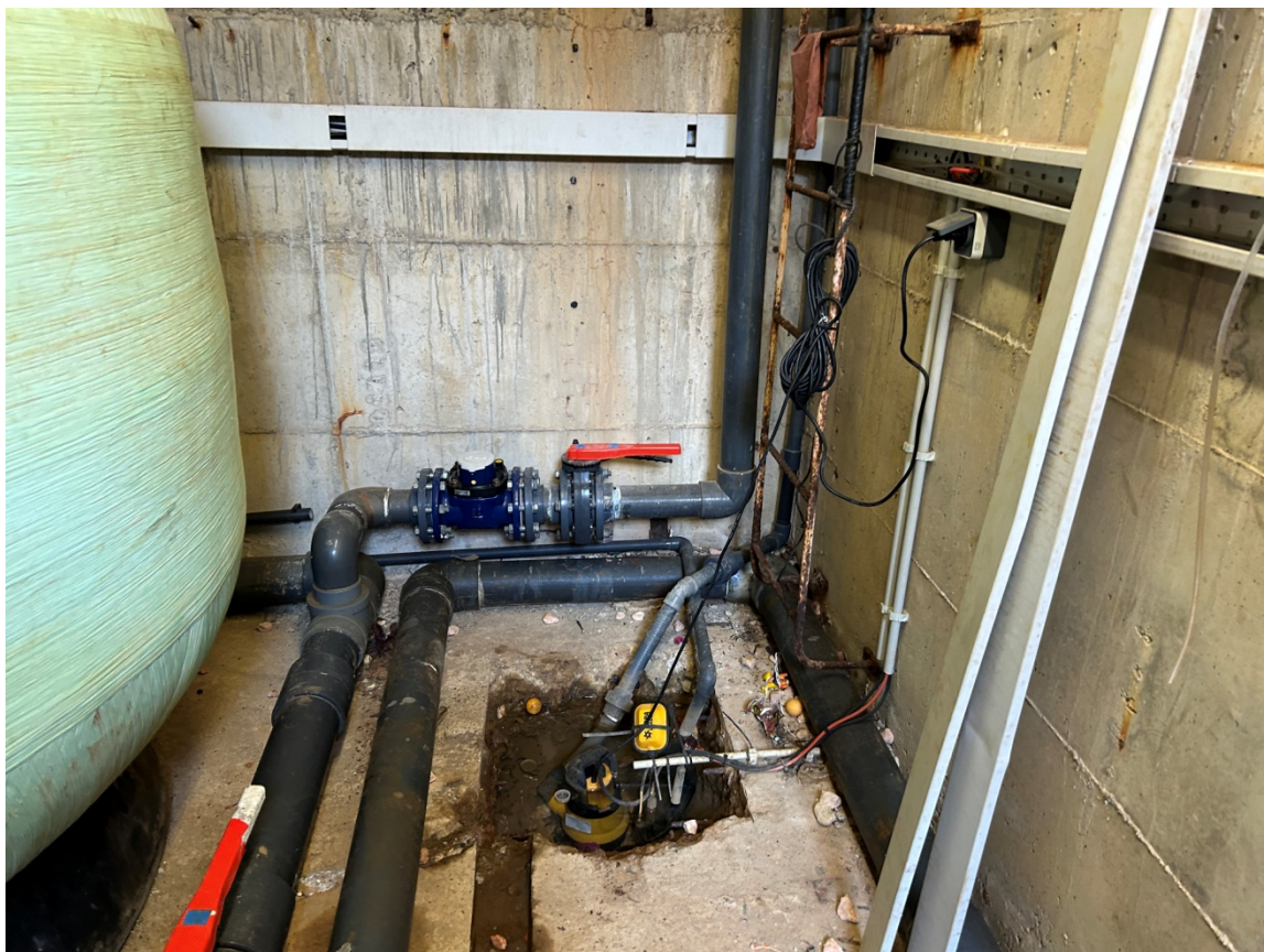
Vista bomba desaigue sala depuració soterrada
