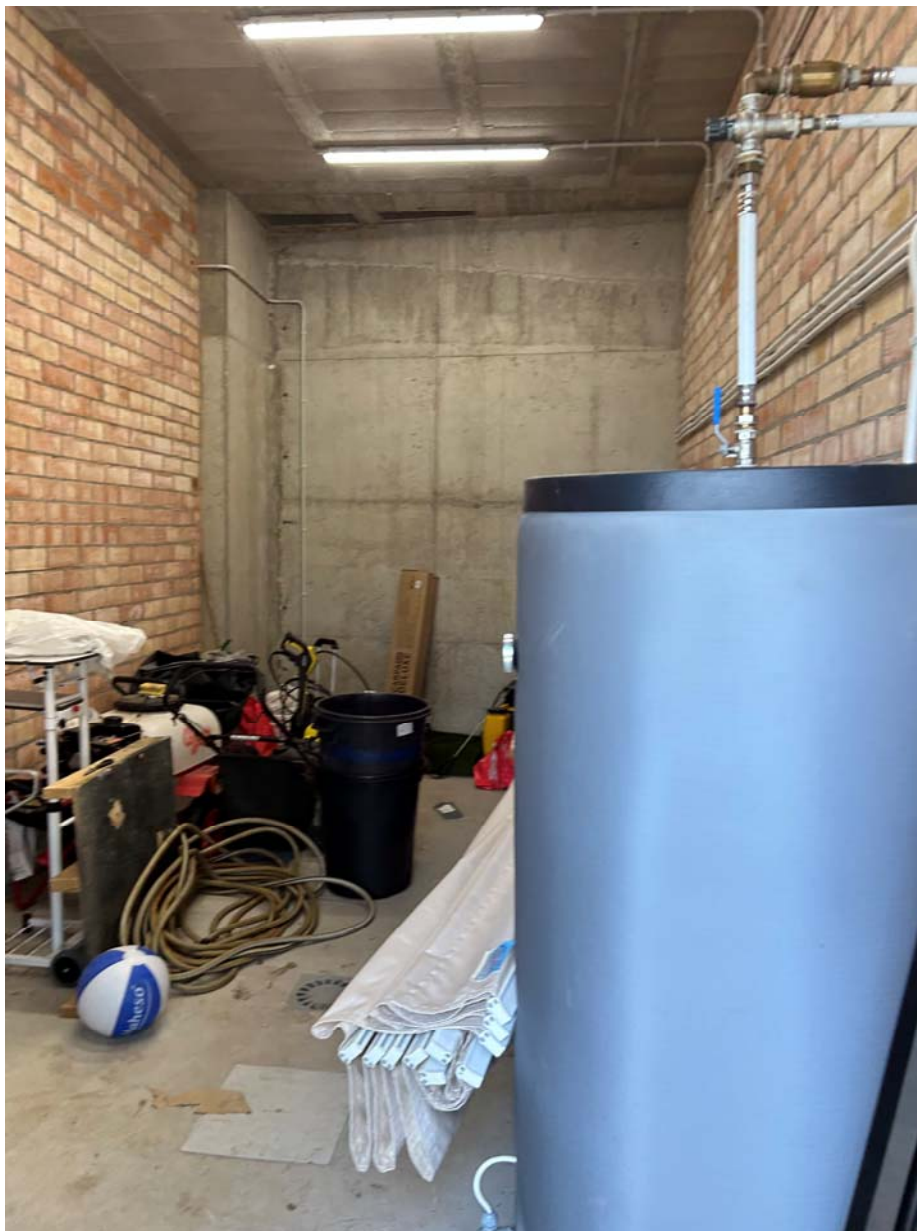
Interior nova sala de filtres
