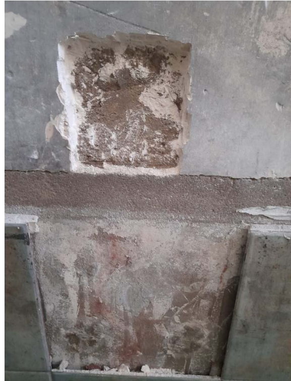
2. Es retira peça ceràmica de l'arrambadori es replica també a la part amb pintura. No es troba cap indici de revestiment original.
