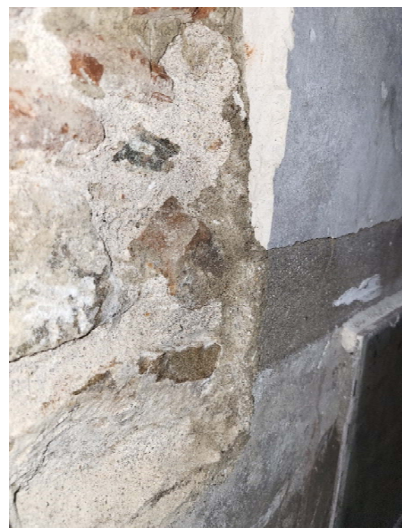
4. Foto detall: Fins a 1,30 trobem un revestiment de morter i a la part superior un revestiment de guix.
