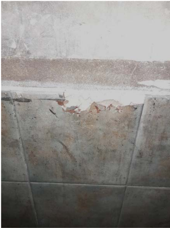
1. Estat inicial: Arrambador de rajola ceràmica fins a 1,20m d'alçada + franja de 10cm de morter + pintat a la part superior
