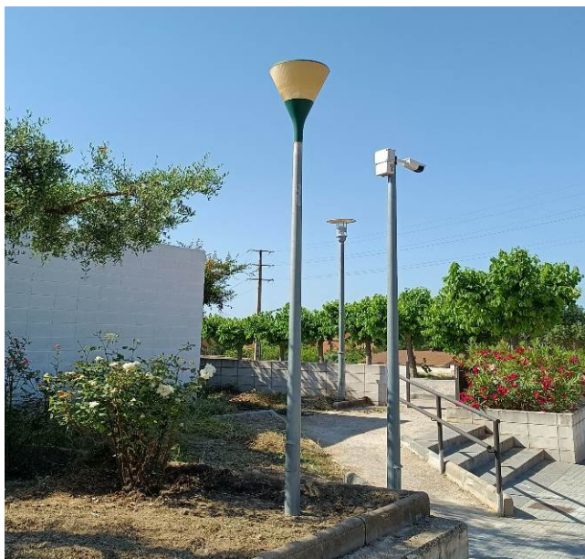
(Columna amb làmpada de descàrrega de 150W)
