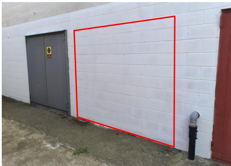
Figura 6. Armari tècnic existent i zona d'ampliació armari tècnic que guardarà la nova TMF-10
