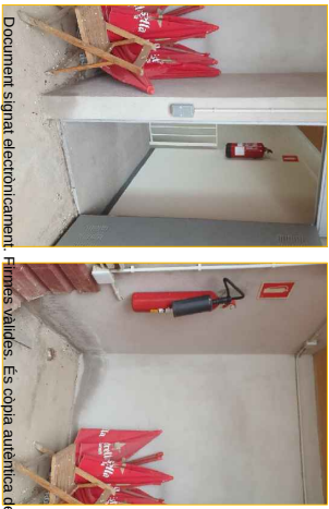
ZONA UBICACIÓ INVERSOR
