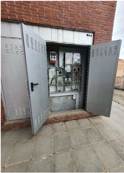
Imatge 1 Escomesa del pavelló esportiu i equip de mesura del consum
