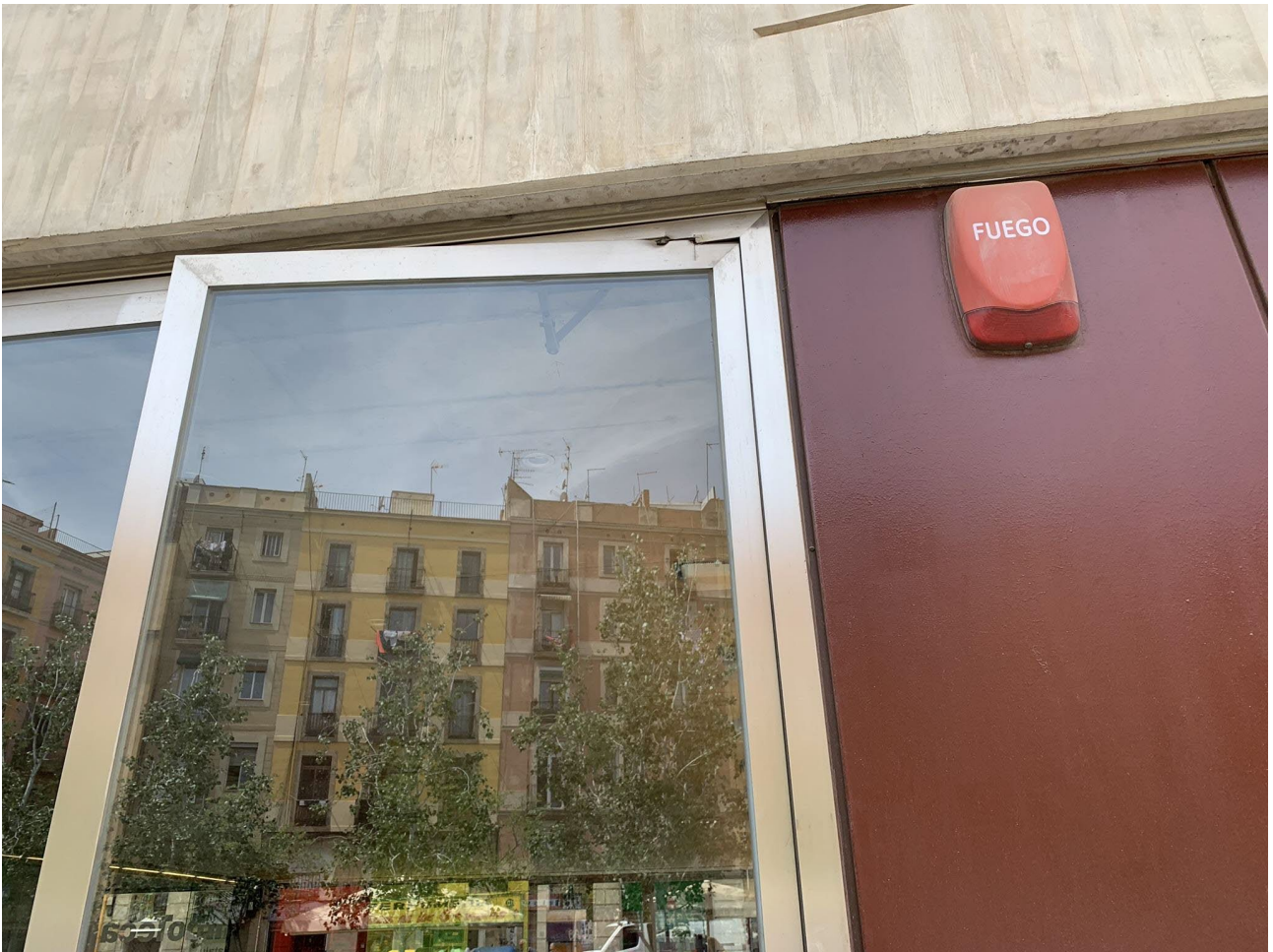
Detall del mecanisme d'obertura malmès - vista des de l'exterior
