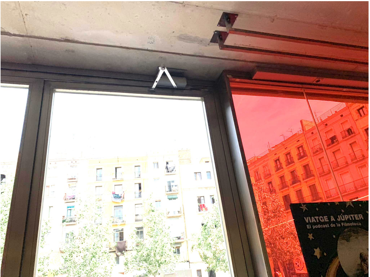
Detall del mecanisme d'obertura malmès - vista des de l'interior
