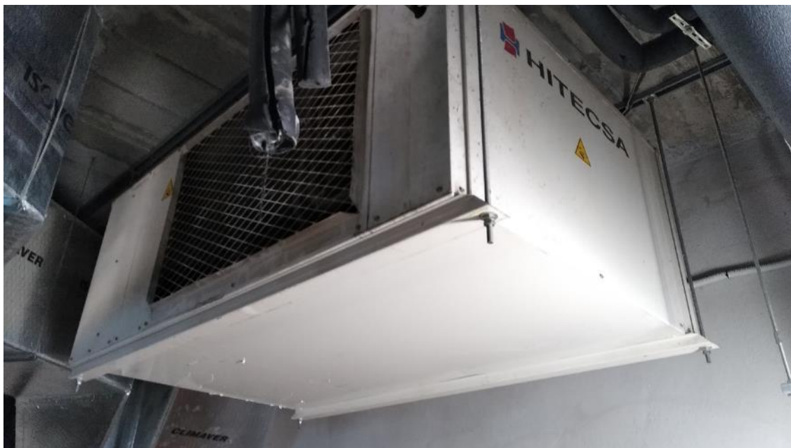
Fotografia 07. Detall de la unitat a retirar de la instal·lació de climatització existent, model ECHZ-1001, any 2007, potència 28.40 kW de la marca Hitecsa.
