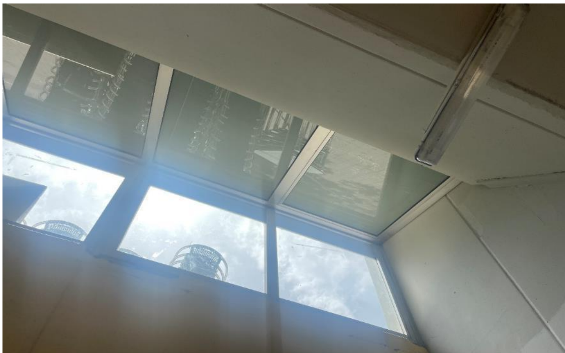
Fotografia 06. Detall 3 zona bar, vista des de la sala 1. Aquesta zona permet l'entrada de llum natural a la planta inferior i es per on discorreran els conductes de la nova instal·lació de renovació d'aire des de planta baixa a planta pis 1. Caldrà retirar la part adossada a la paret per dur a terme la intervenció prevista.
