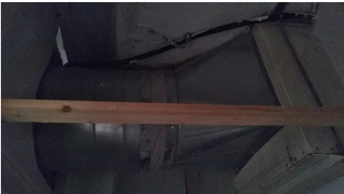
Fotografia 11. Detall màquina existent a desmuntar i retirar, ubicada al fals sostre del vestuari A.
