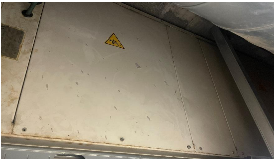
Fotografia 12. Detall unitat existent a retirar, model ECHZ-1001, any 2007, potència 28.40 kW de la marca Hitecsa, ubicada al fals sostre del vestuari A.
