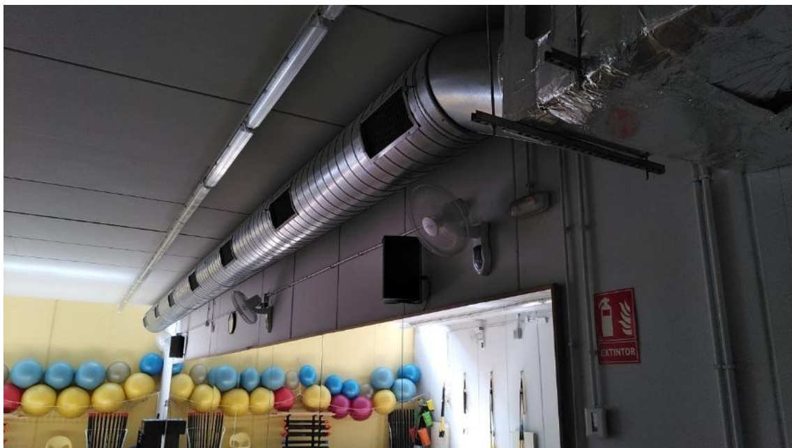
Fotografia 03. Detall 2 estat conductes existents de la instal·lació de climatització, que s'aprofitaran per la nova instal·lació de ventilació.
