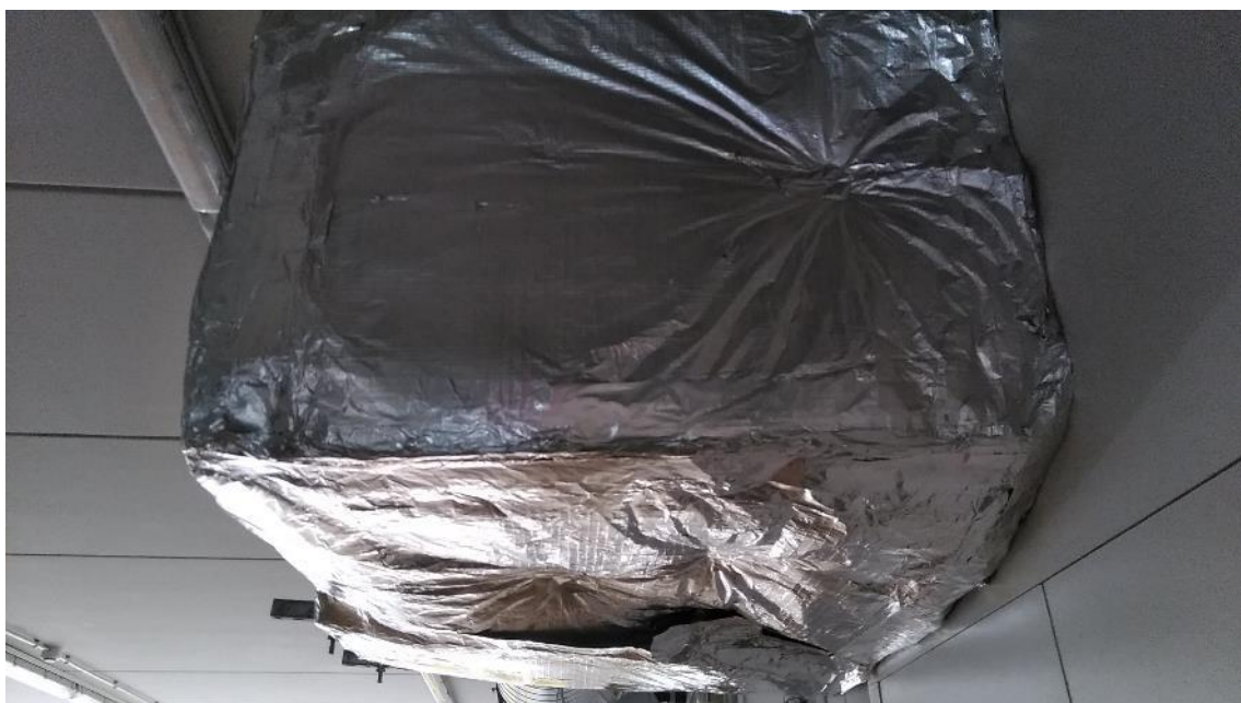
Fotografia 10. Element existent a desmuntar i retirar de la instal·lació de climatització ubicat a la sala 1.
