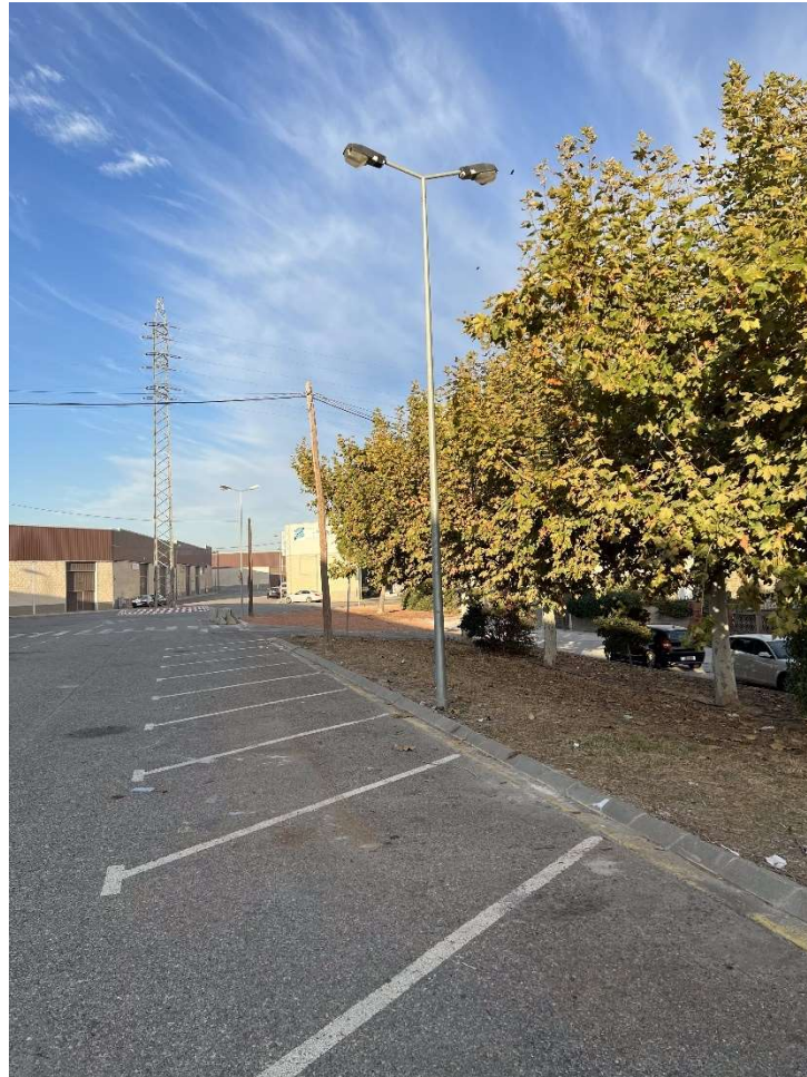
Fotografia 3: Lluminaària tipus Vial existent a substituir
