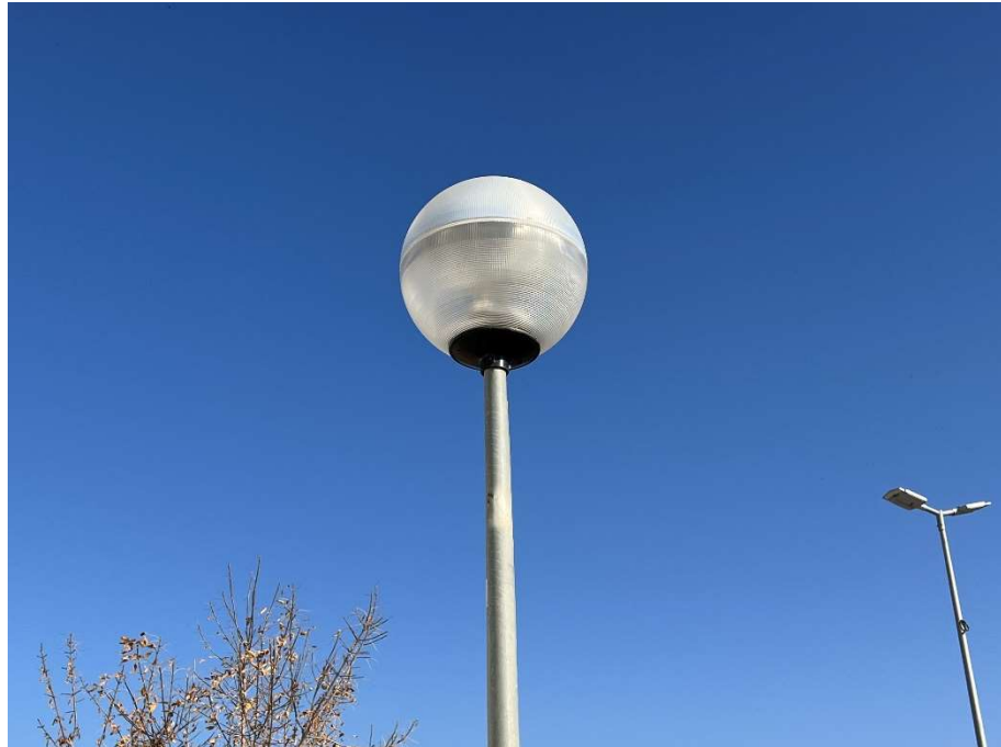
Fotografia 1: L·luminària tipus Globus existent a substituir
