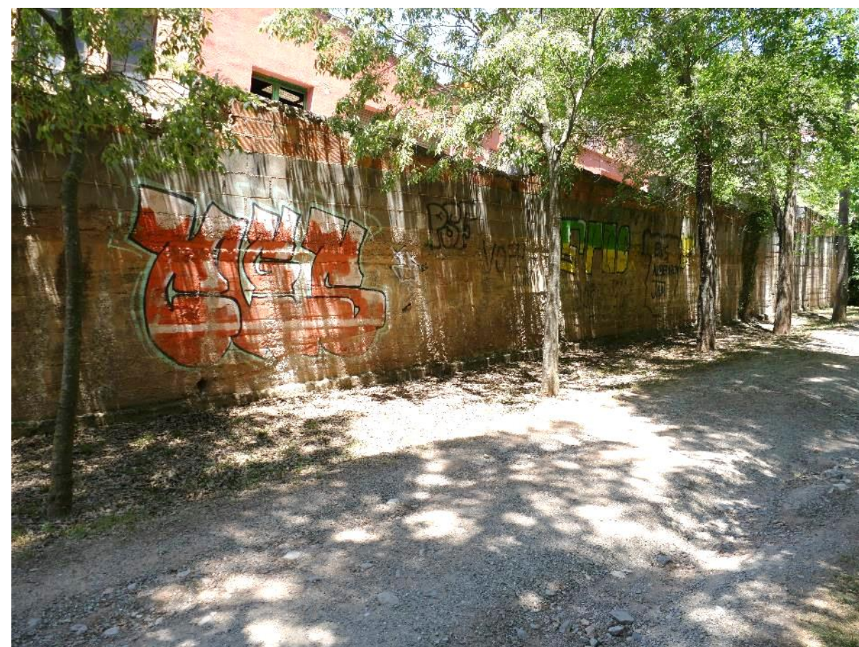
Mur Carrer Salt per l'interior caigut parcialment reparat amb diferent tipus d'elements d'obra
