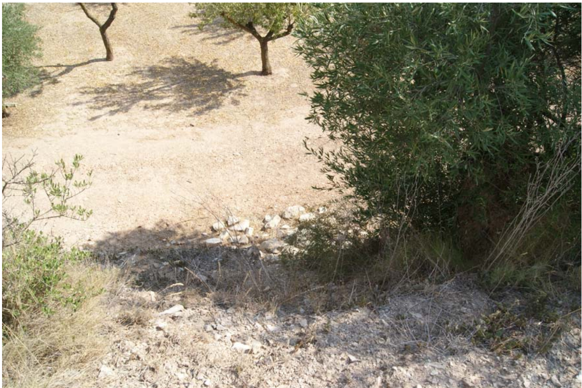
Vista inferior i superior de l'esllavissada 1 d'un tram de mur de pedra, de 2,00 de llarg i 2,00 m d'alçada. S'hauria de refer un tram més del que ha estat enderrocat.
