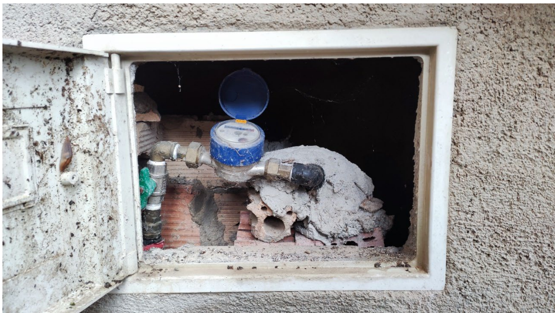
Figura 8: Comptador instal·lat dins d'un cofre
