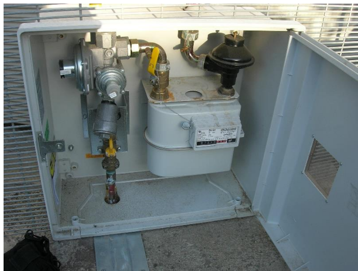
Foto 7: Interior de l'armari de comptatge de Rubí Instal·lacions Fixes
