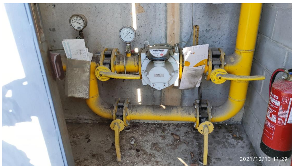
Foto 10: Interior de l'armari de comptatge de Rubí Taller
