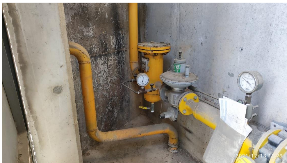
Foto 9: Interior de l'armari de comptatge de Rubí Taller
