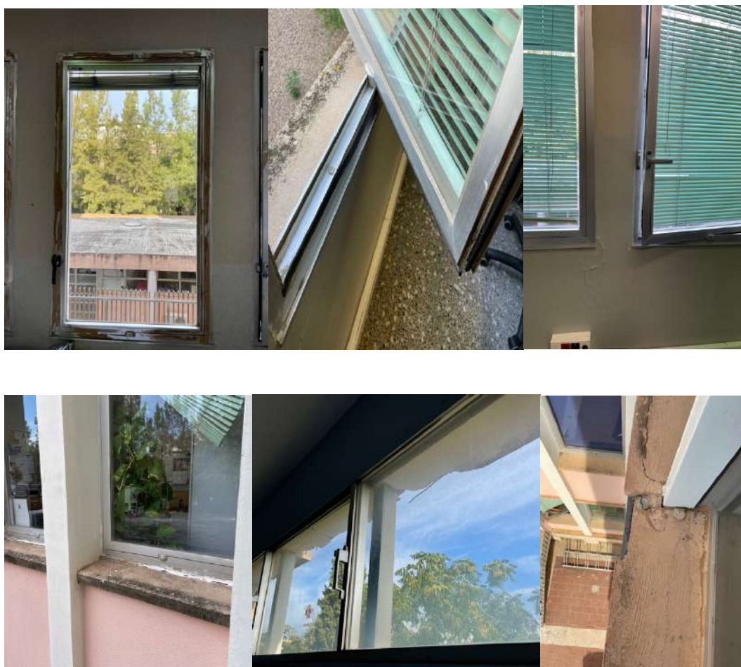
Estat dels diferents elements de façana i finestres
