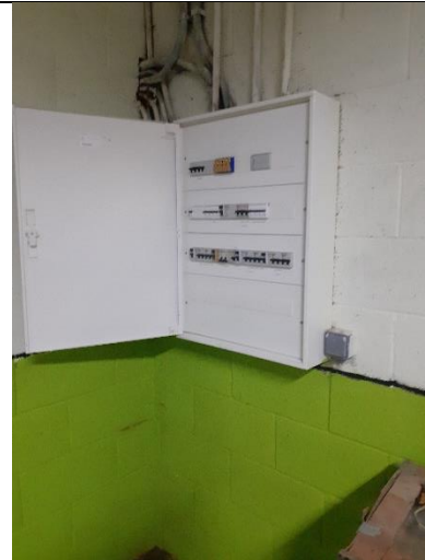
Foto 10.- Quadre elèctric actual remodelat recentment
