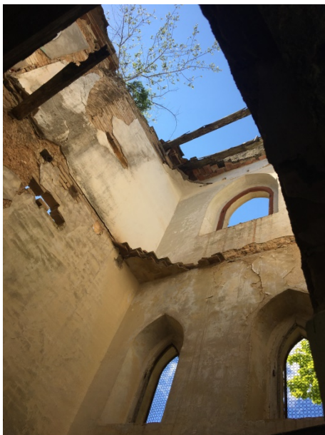
Torre lateral en runes
