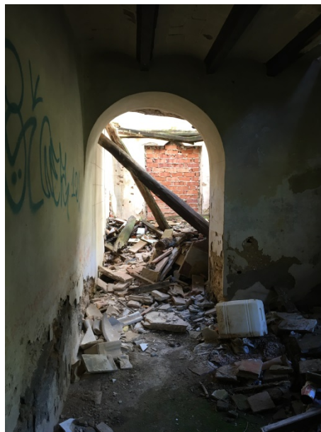
Nau lateral en mal estat
