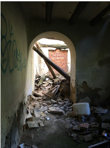
Forjat torreta completament caigut
