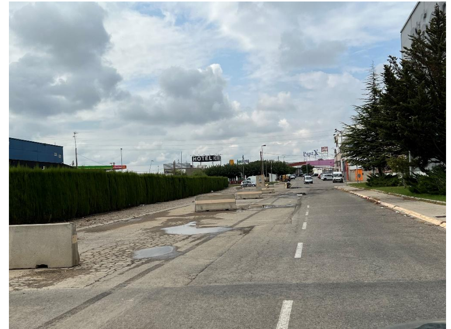
F21. C/ de Baix. Zona d'acumulació d'aigües i millora del ferm
