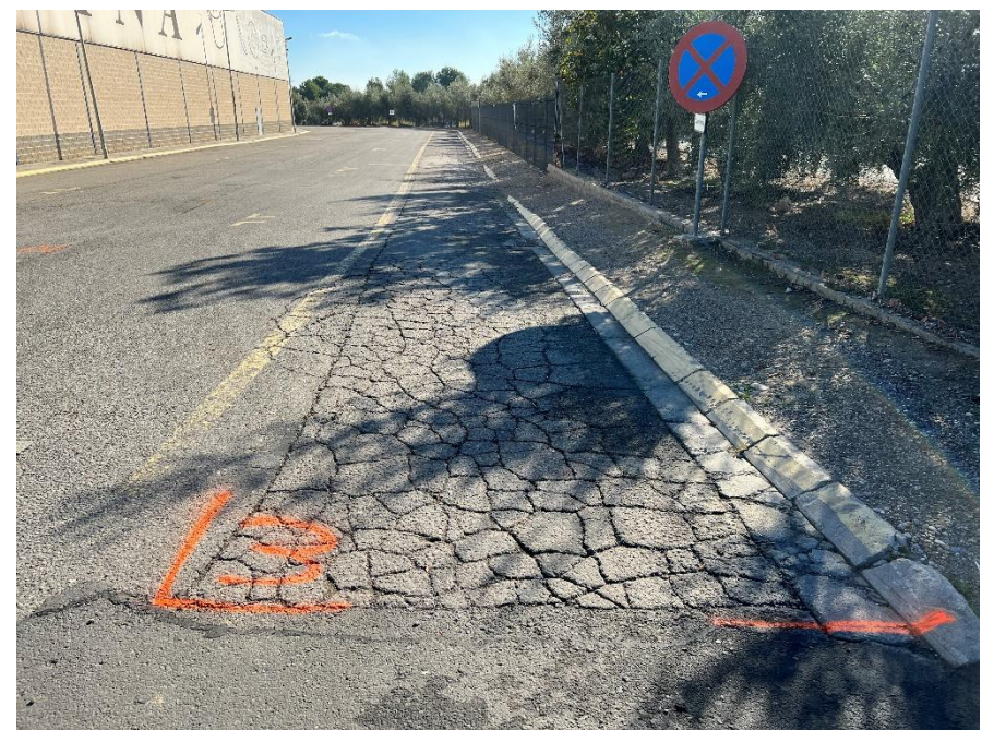
F06. C/ Tramuntana. Actuació 3. Reparació flonjall al ferm i restitució de vorada i rigola a tota la longitud
