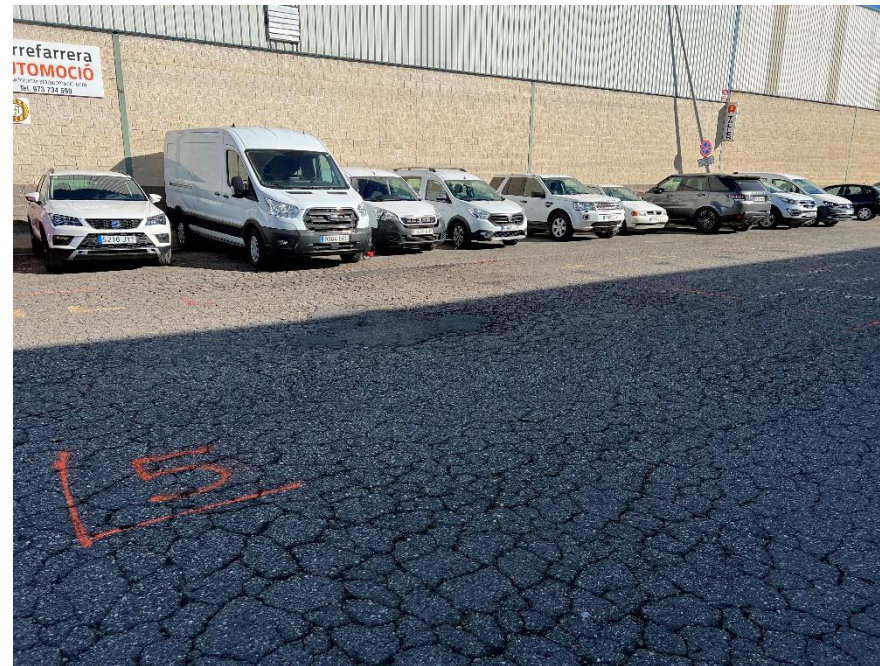
F08. C/ Indústria. Actuació 5. Reparació flonjall al ferm a l'inici carrer
