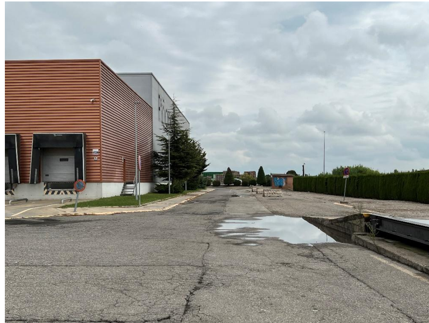
F20. C/ de Baix. Zona d'acumulació d'aigües i millora del ferm
