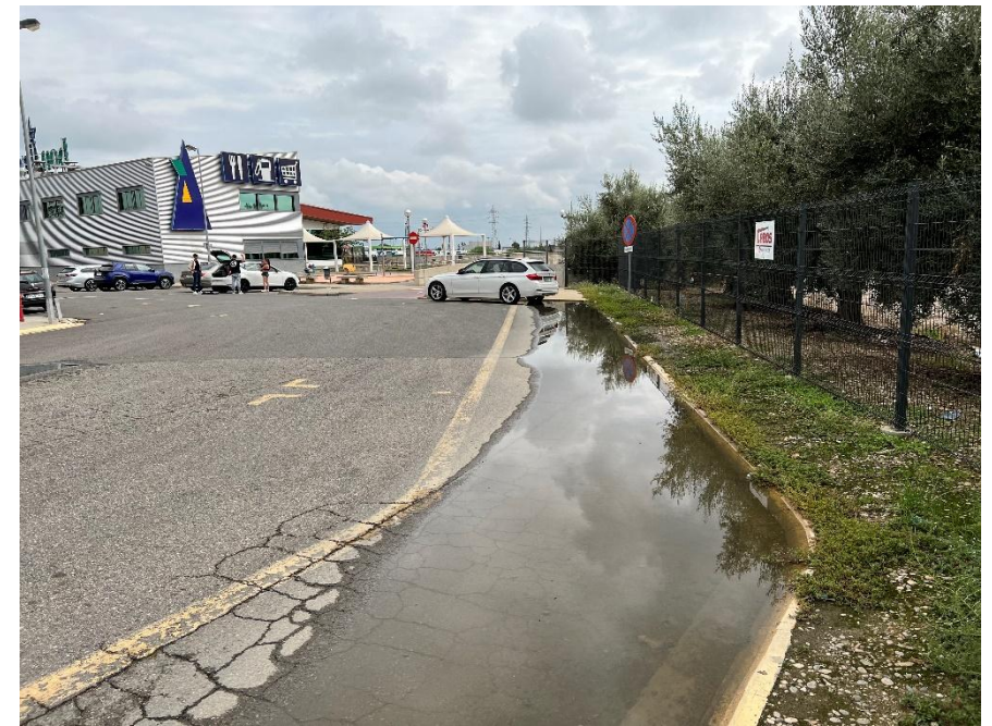
F03. C/ Tramuntana. Acumulació aigua zona inicial
