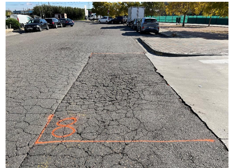
F12. C/ Indústria. Actuació 8. Reparació flonjall al ferm davant rentador vehicles
