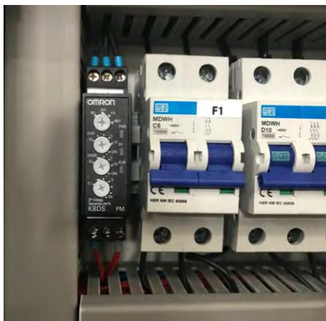
Parte del cuadro eléctrico: a la izquierda, controlador de fases mejorado (EXCELLENT).
