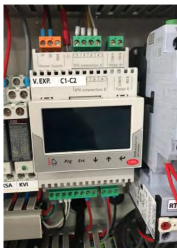
Display de la válvula en cuadro eléctrico
