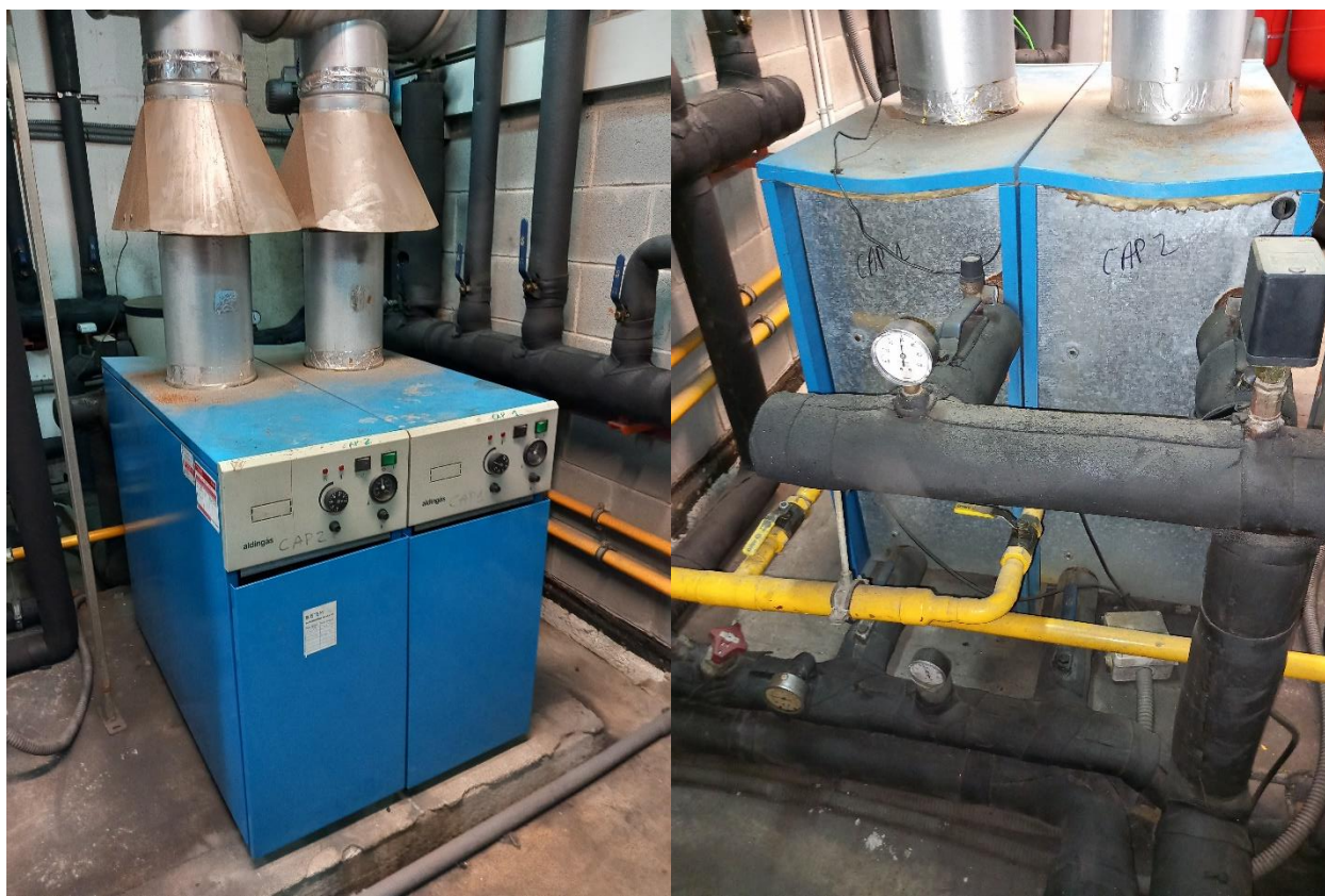
Foto 5: Caldera a Substituir
