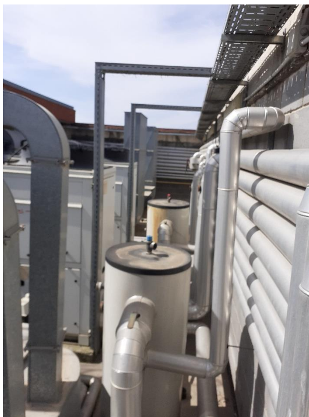
Foto 2: Imatge dels dipòsits de inèrcia.
