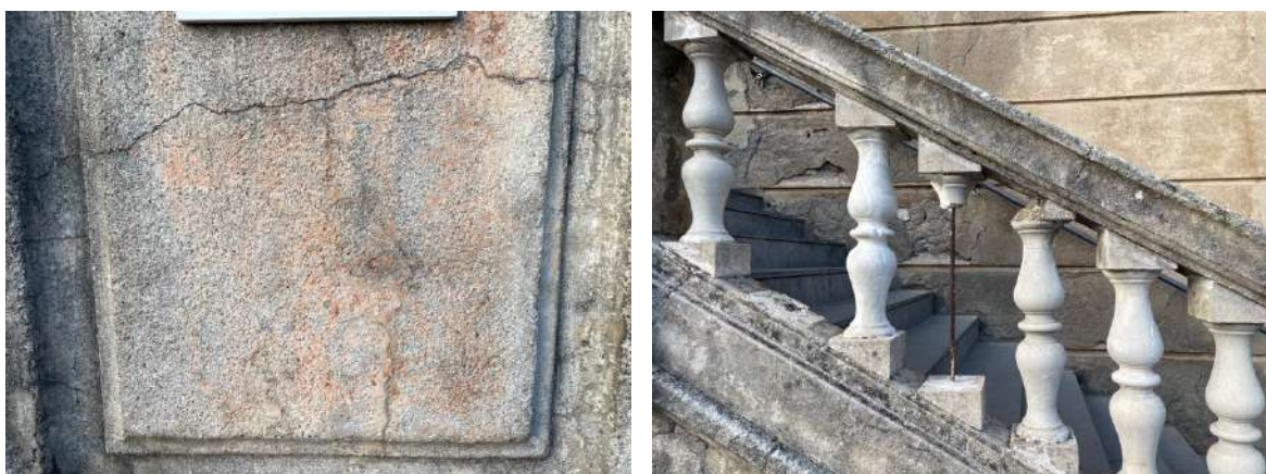
Fotografies detall de les fissures en la balustrada, a més de la pèrdua de suport
