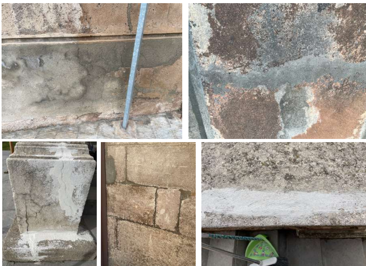
Fotografies detall de diferents morters de reparació
