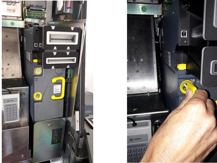
Figura 23. Clau i pany de desbloqueig del bitlleter
